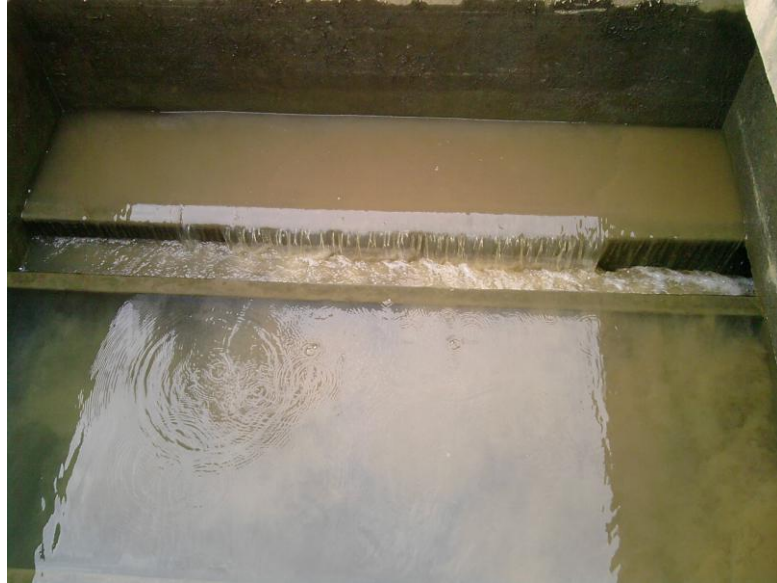
Fotografia 2: processo de retro lavagem de filtros. Fonte Heineken
