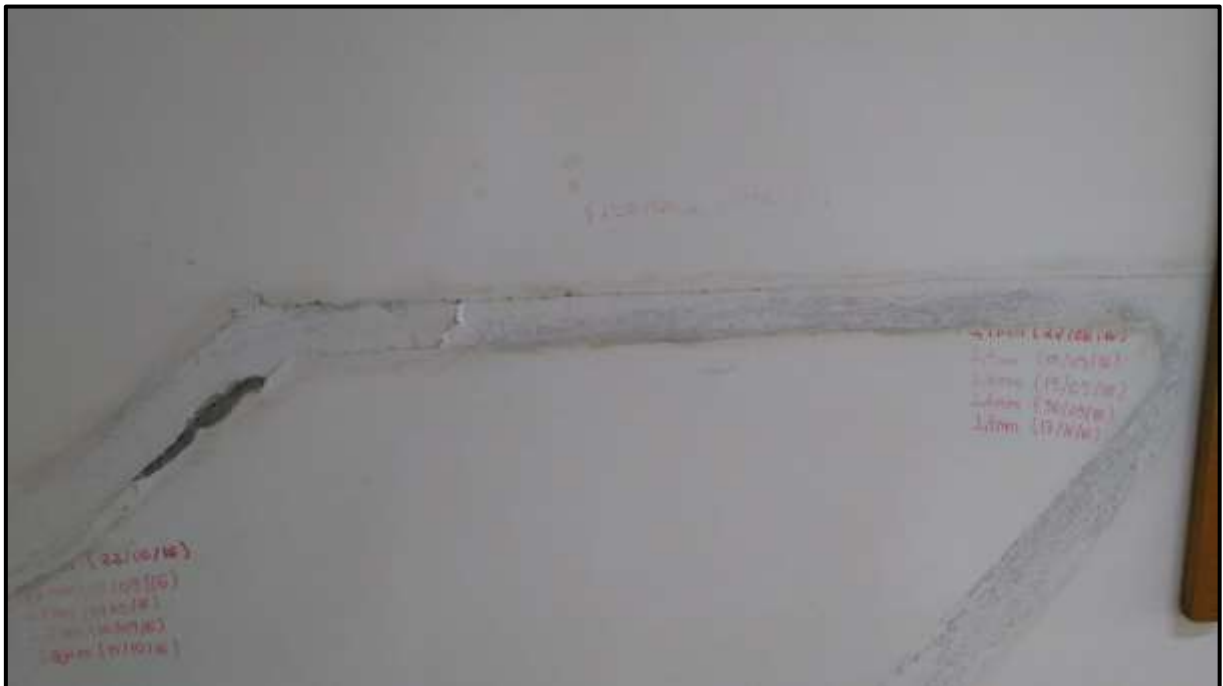
Imagem 03 – Junção da fissura da imagem 02 com outra fissura.
