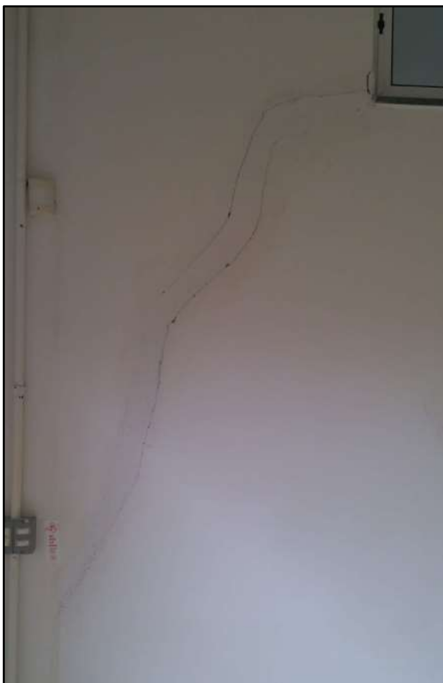
Imagem 07 – Fissura na quina de outra janela do corredor.
