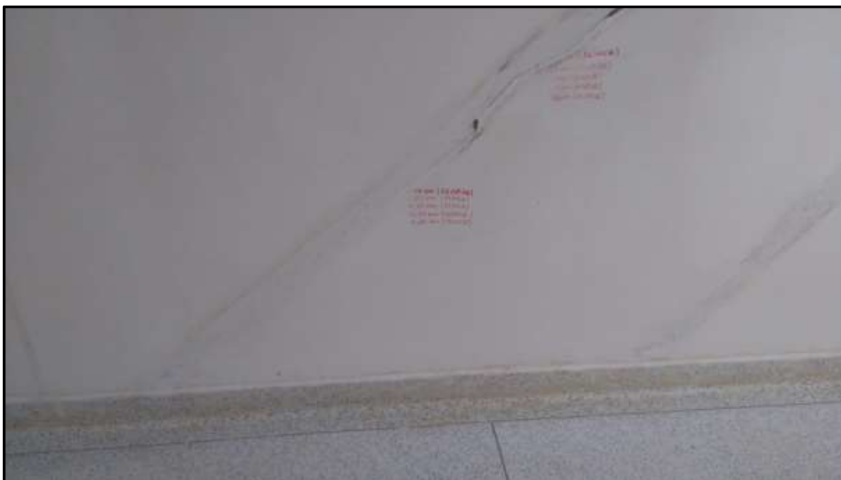
Imagem 01 – Fissura com início no piso.
