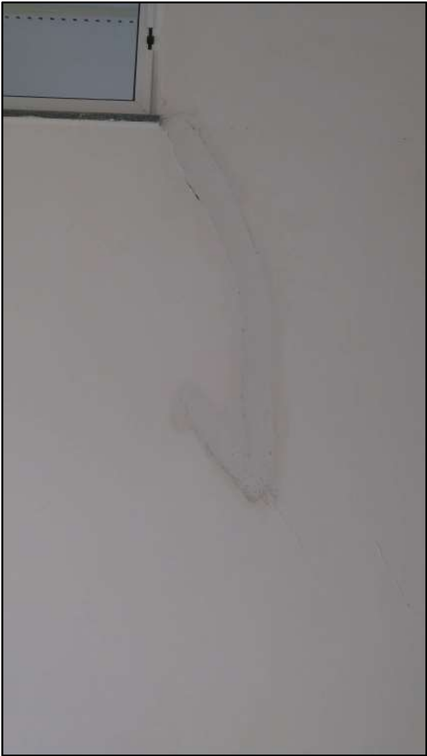
Imagem 05 – Fissura na quina da janela do corredor.
