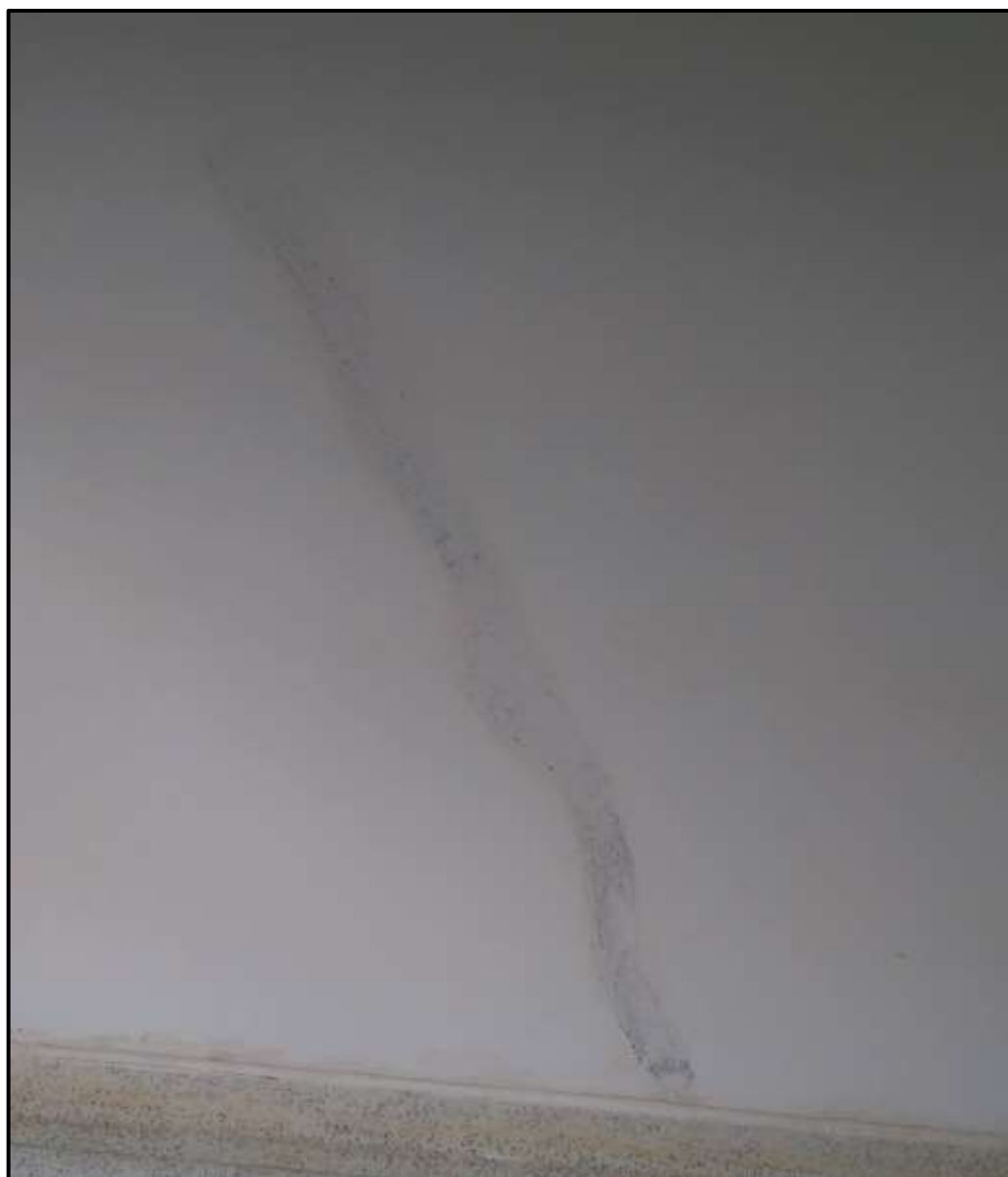
Imagem 06 – Fissura com início no piso e término no meio da parede.
