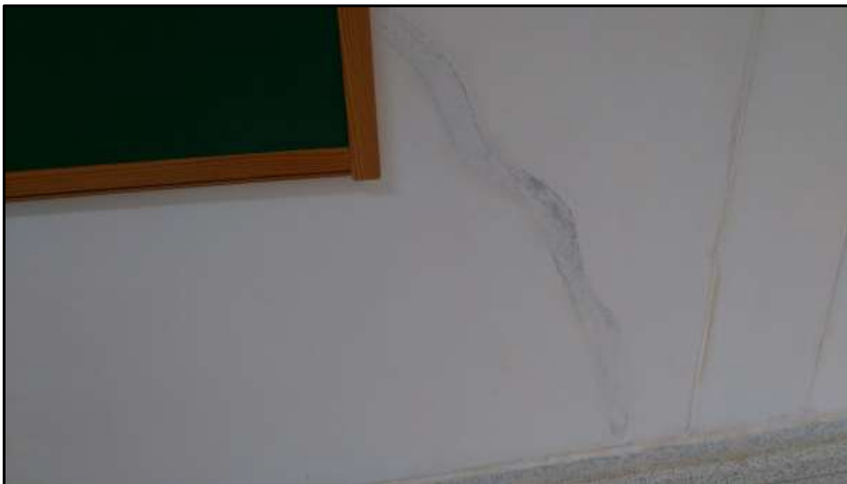
Imagem 04 – Termino da fissura da imagem 01.
