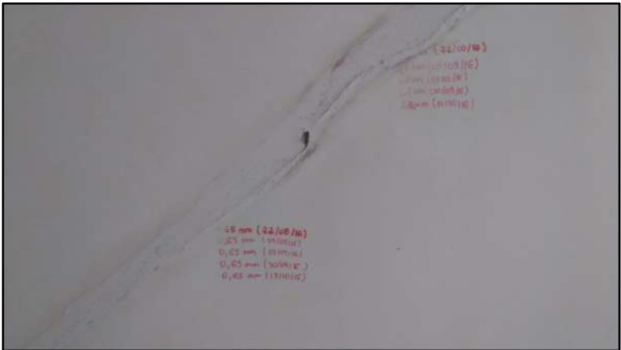
Imagem 02 – Controle técnico do aumento das fissuras.
