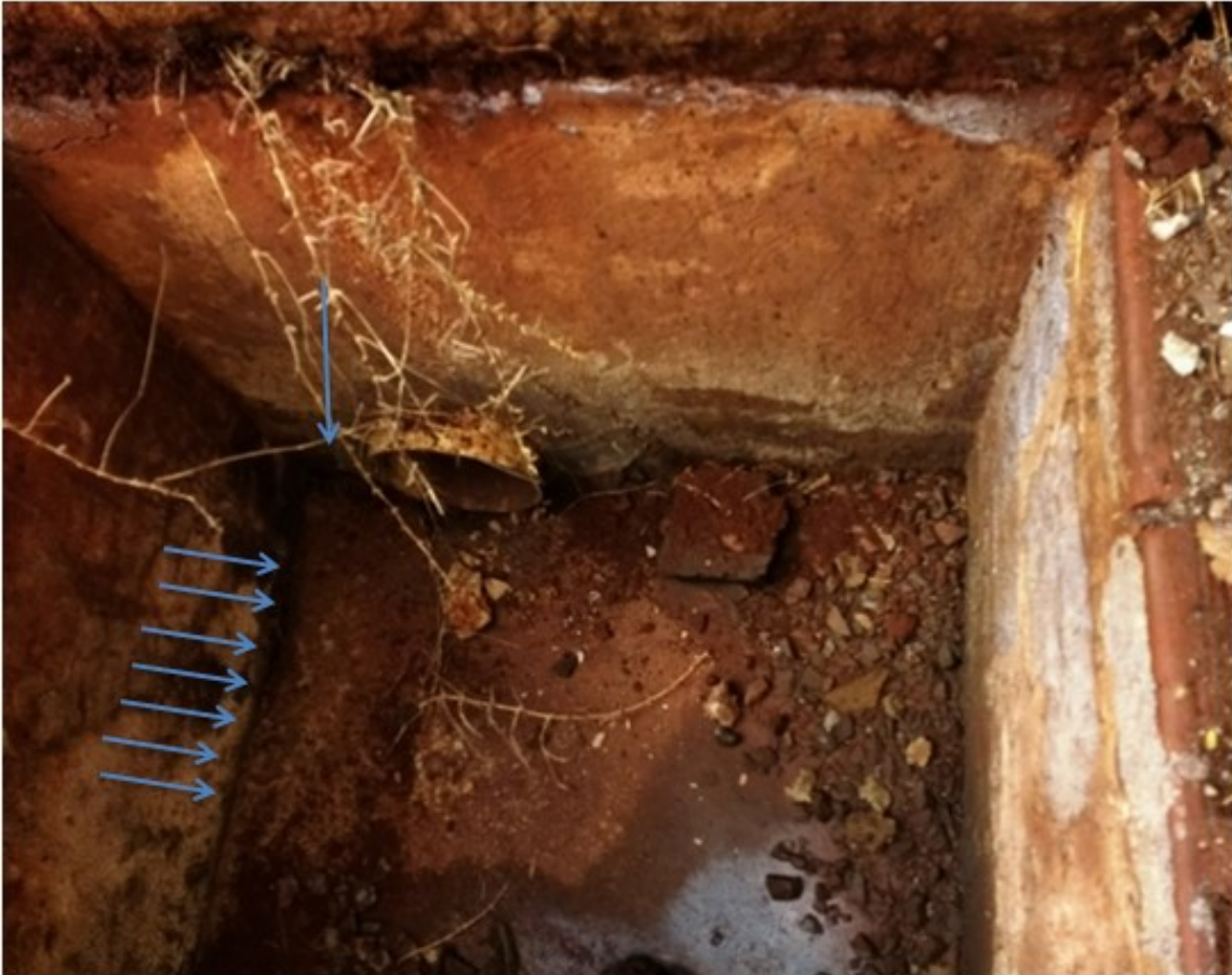
Imagem 18: Destacamento do fundo da caixa de passagem de água pluvial 2.
