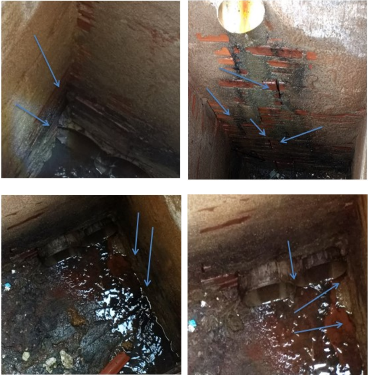
Imagem 15: Fissuras na caixa de passagem de esgoto.
