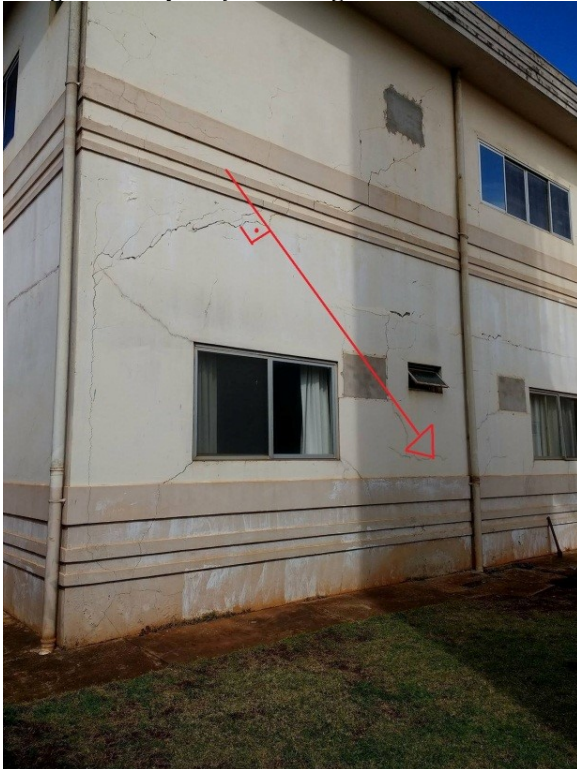
Imagem 11: Aplicação da Regra da Mediatriz na Fissura D.
