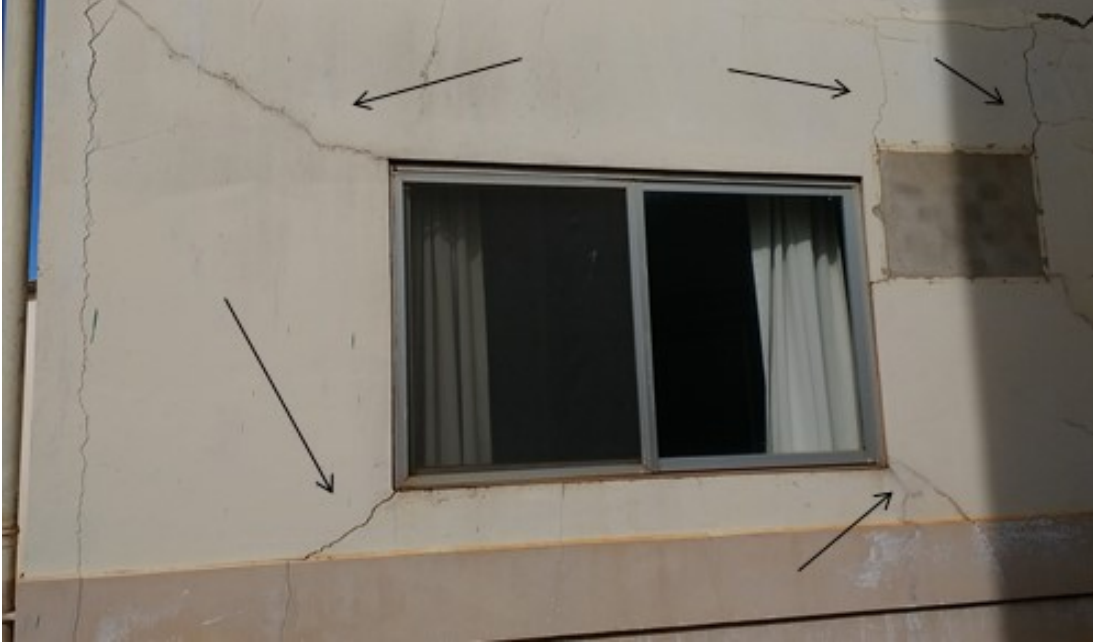
Imagem 9: Fissuras "B" aproximadas
