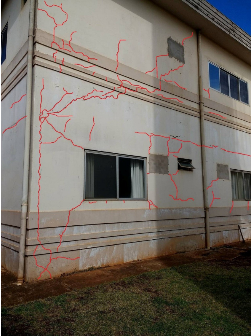
Imagem 5: Mapeamento das fissuras.
