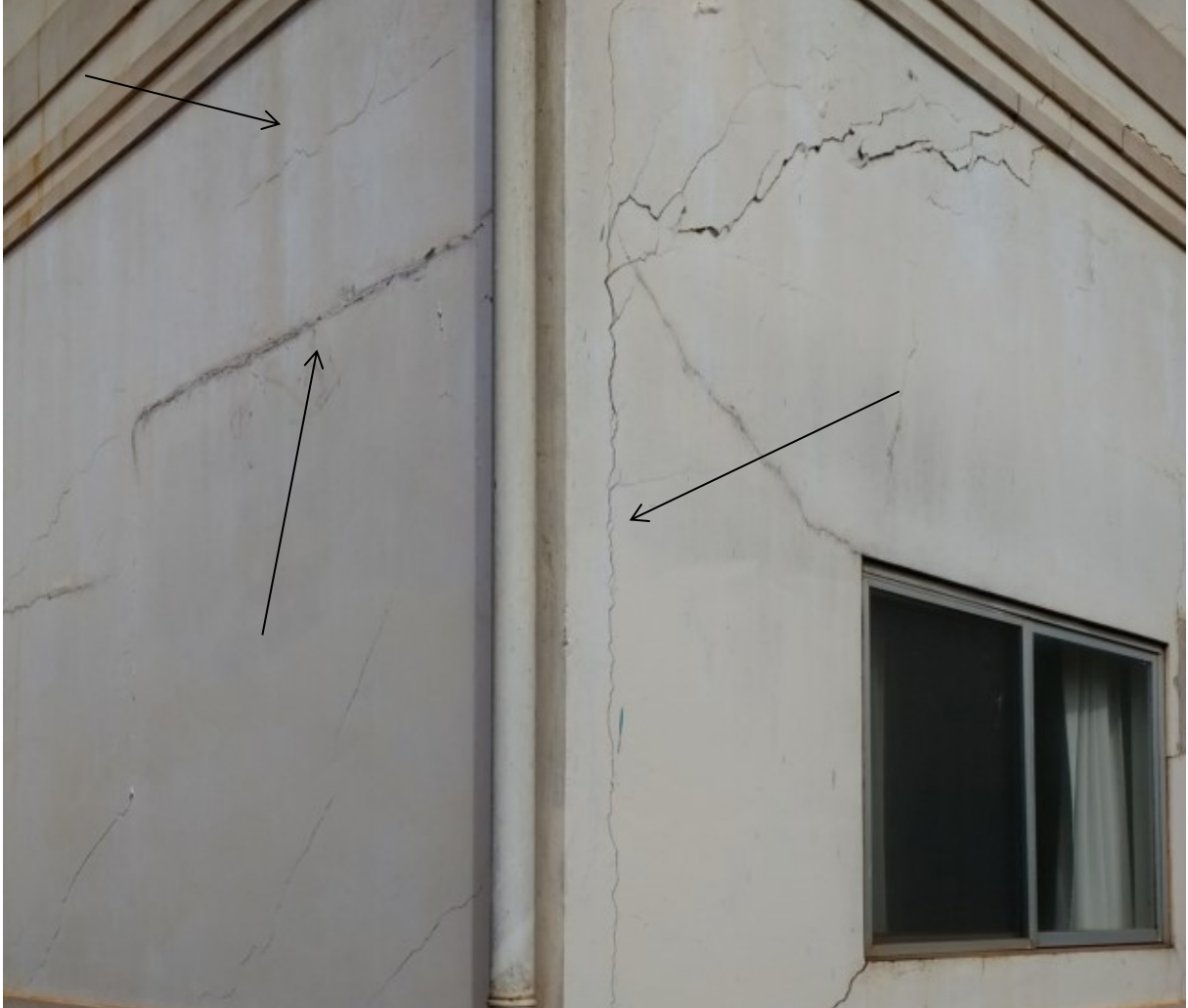
Imagem 7: Destacamento entre a alvenaria e elementos de concreto por dilatação térmica.
