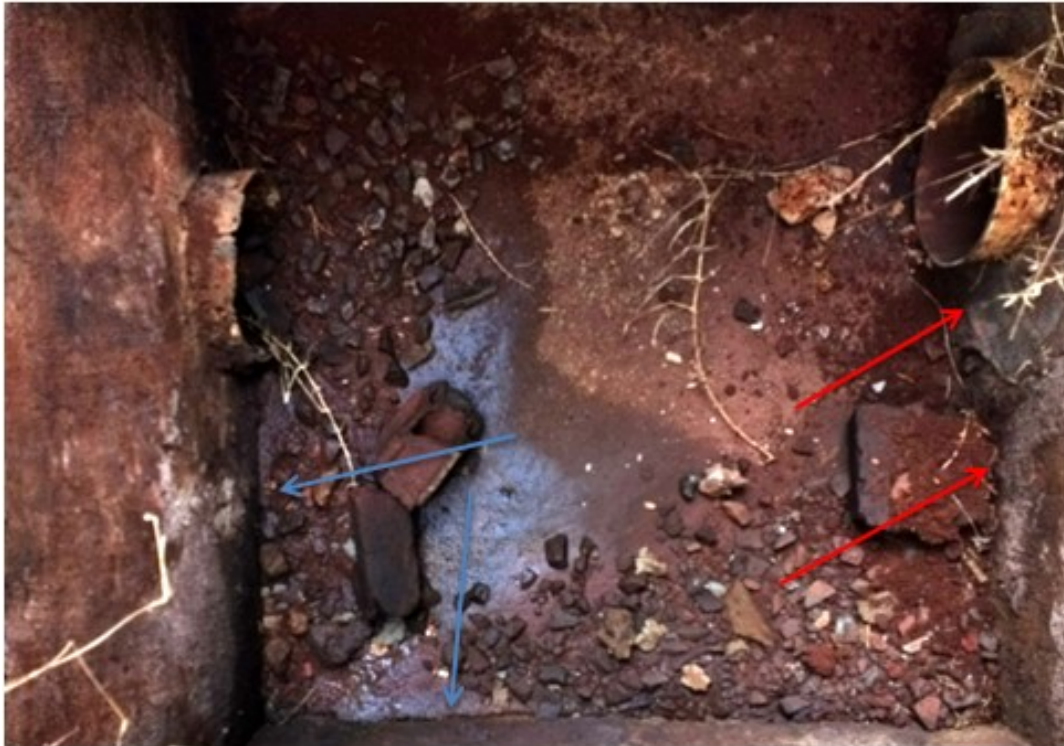
Imagem 17: Fissuras no fundo da caixa de água pluvial 2.
