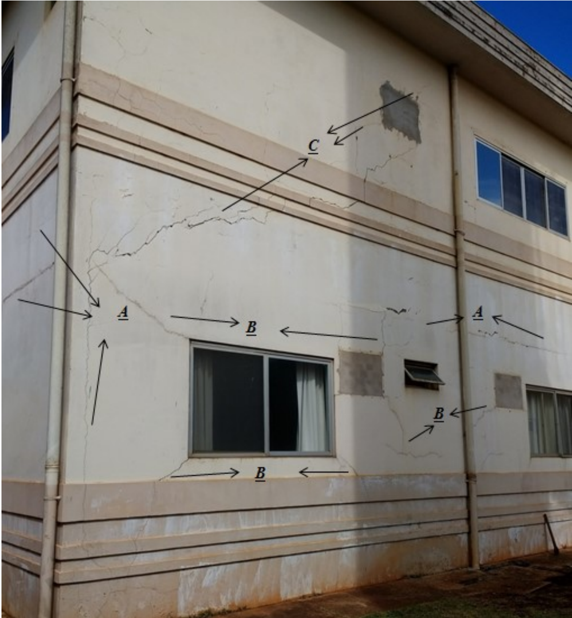
Imagem 6: Identificação de fissuras
