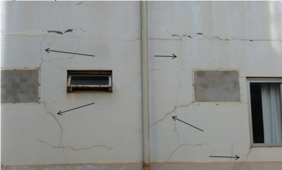
Imagem 10: Destaque das fissuras em aberturas
