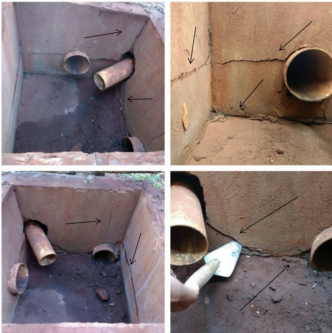
Imagem 16: Fissuras na caixa de passagem de água pluvial 1.
