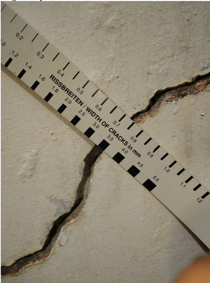
Imagem 8: Espessura da fissura "B".
