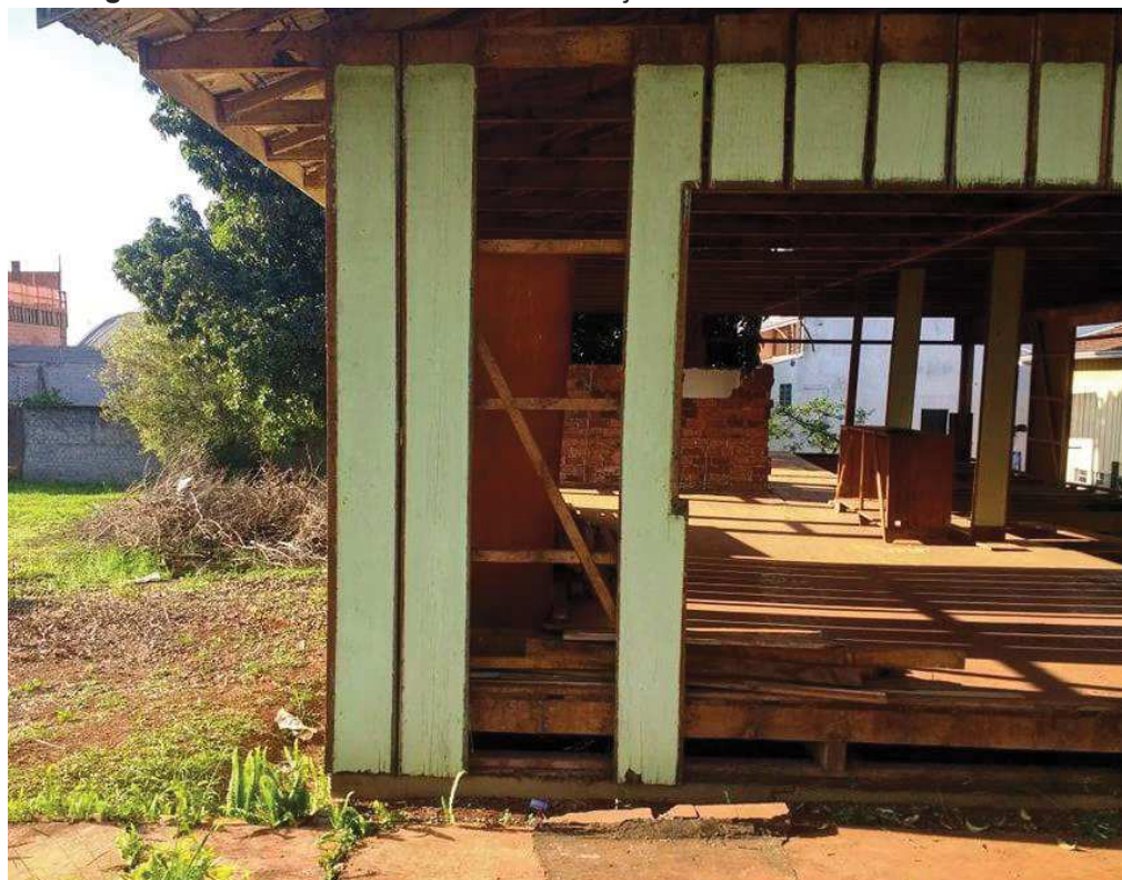
Figura 8 - Casa em desmonte sem mata-juntas em Cascavel - PR.
