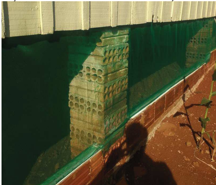
Figura 31 – Pilarete em tijolos furados de uma casa de tábua e mata-junta em Capanema – PR.
