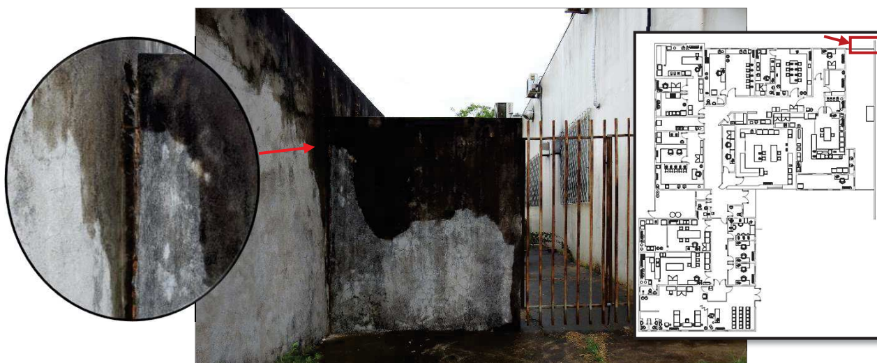
Figura 24 - Deslocamento do muro por adensamento do solo
