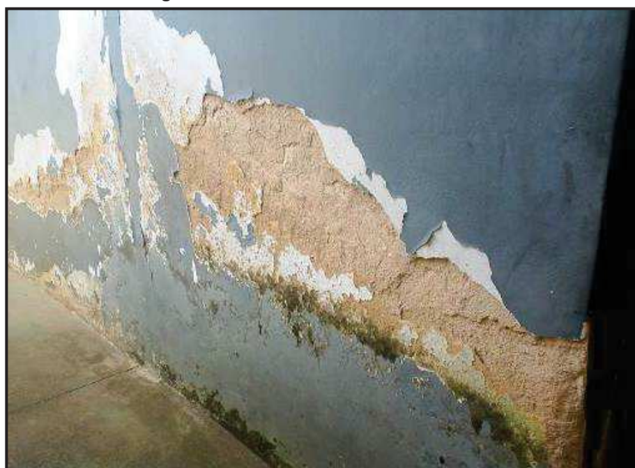
Figura 7 – Descolamento do revestimento
