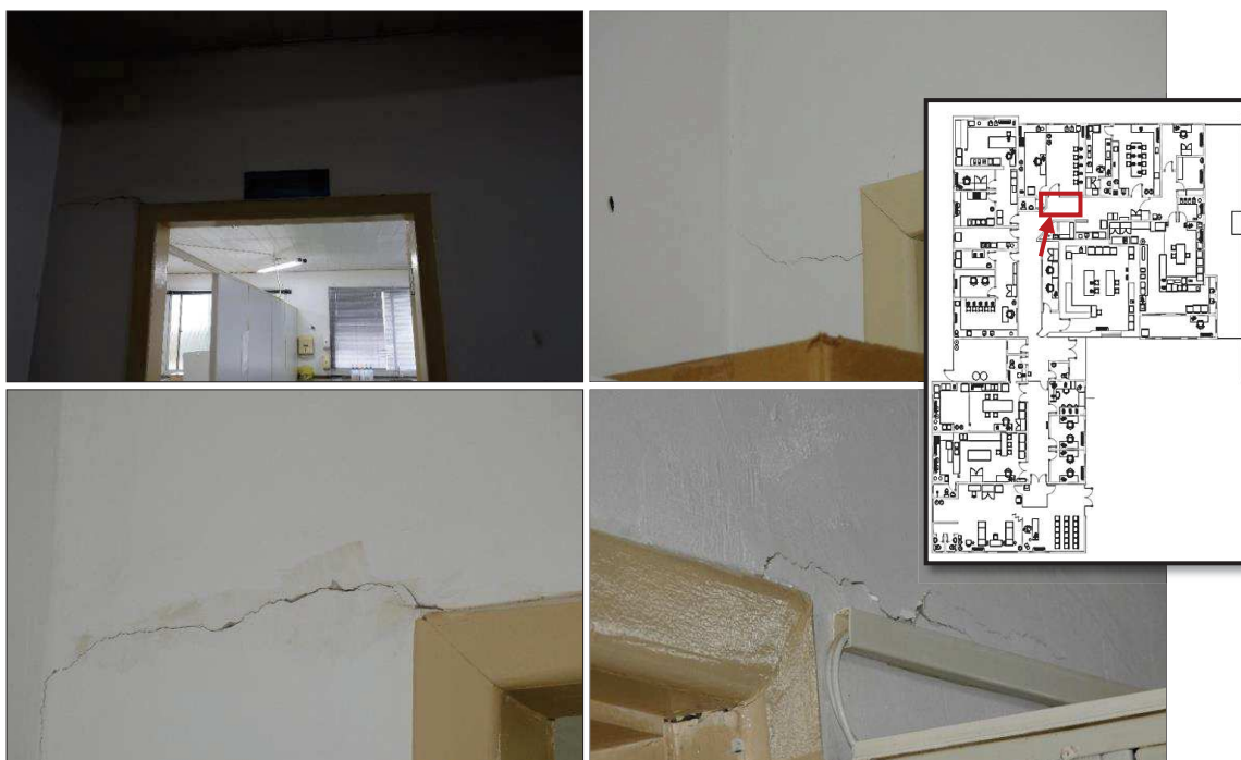
Figura 16 - Fissuras próximo da abertura das portas
