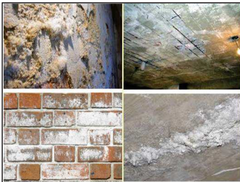
Figura 5 - Ocorrência de eflorescência
