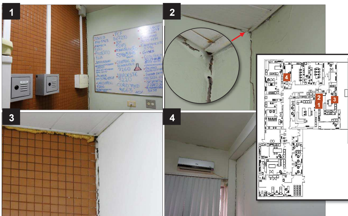
Figura 30 - Deslocamento nos cantos devido ao recalque diferencial
