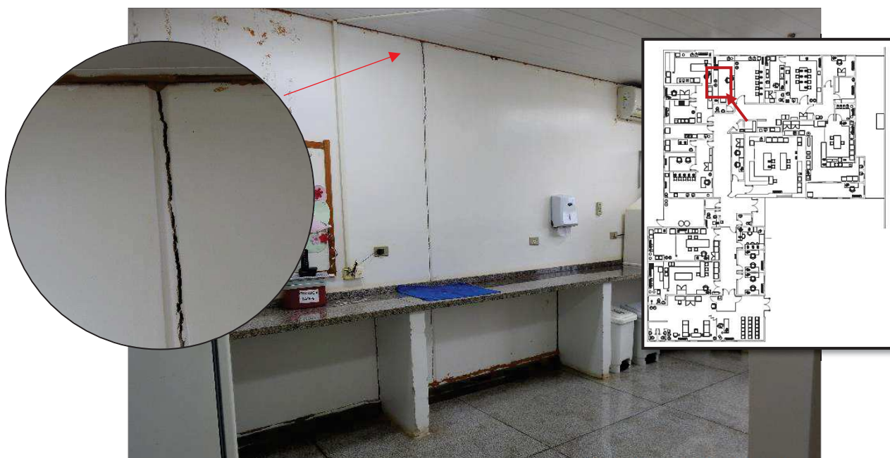
Figura 27 - Trinca devido ao recalque diferencial
