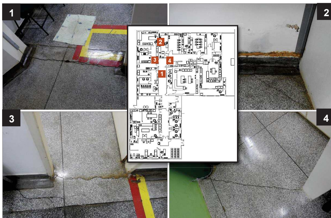
Figura 23 – Fraturas nos pisos
