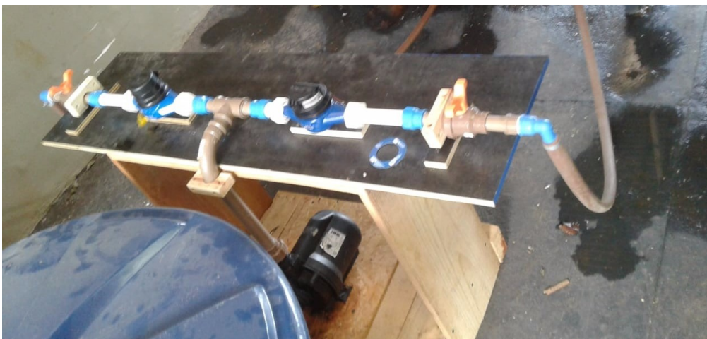
Figura 8: Bomba e conexões.
