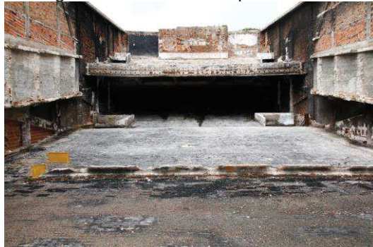
Figura 21- A estrutura após incêndio
