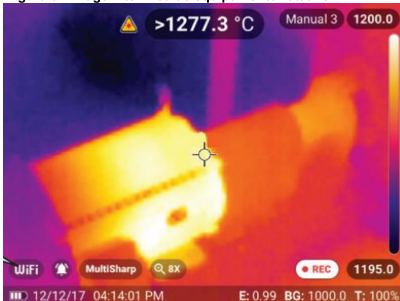
Figura 6 - Imagem térmica de equipamento rotativo
