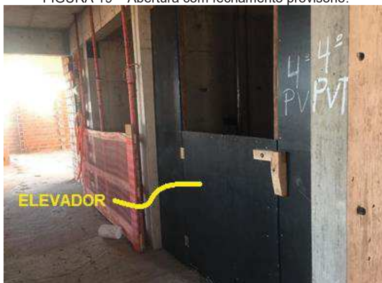
FIGURA 19 – Abertura com fechamento provisório.
