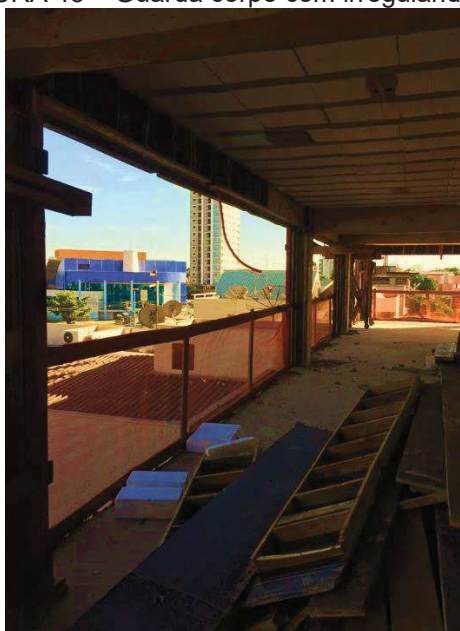
FIGURA 43 – Guarda corpo com irregularidades.
