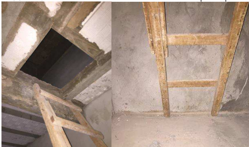
FIGURA 29 – Escada de mão sem ter 1 metro acima do piso superior.
