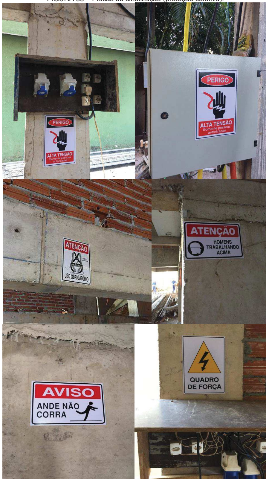
FIGURA 38 – Placas de sinalização (proteção coletiva).
