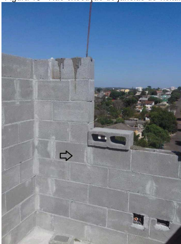
Figura 18 - Não execução de janelas de visita.
