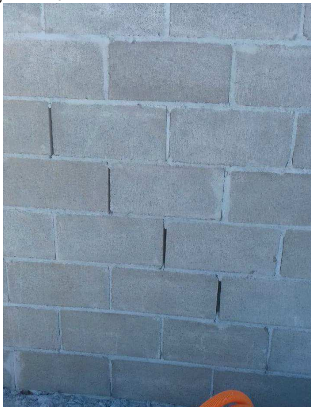
Figura 24 - Juntas secas devido ao método construtivo.
