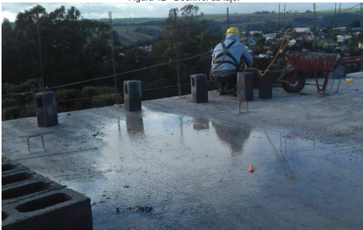
Figura 12 - Desnível da laje.
