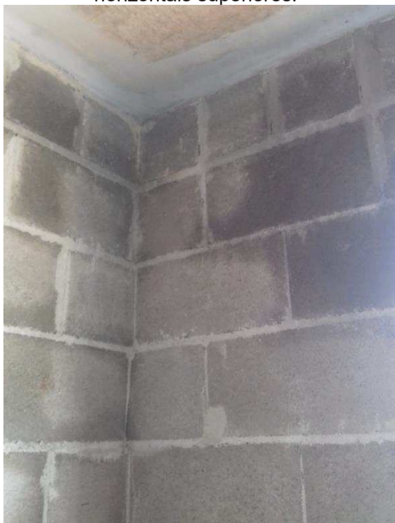
Figura 20 - Juntas espessas nas fiadas horizontais superiores.
