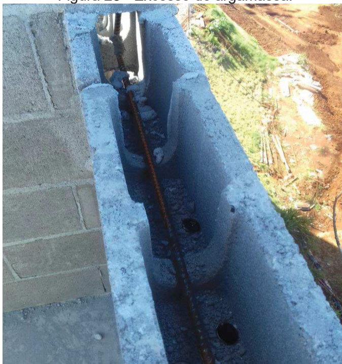
Figura 28 - Excesso de argamassa.
