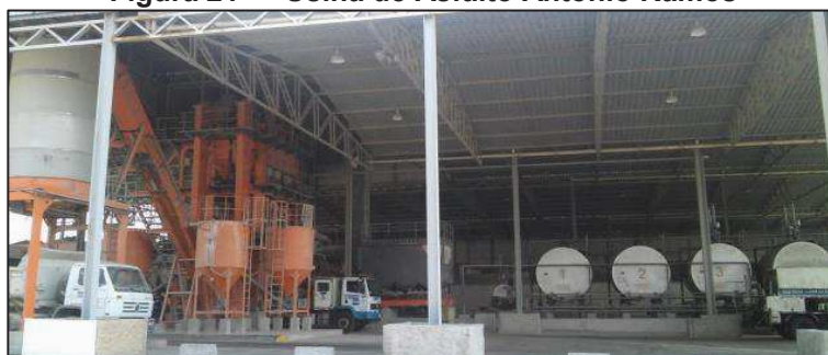
Figura 21 — Usina de Asfalto Antônio Ramos
