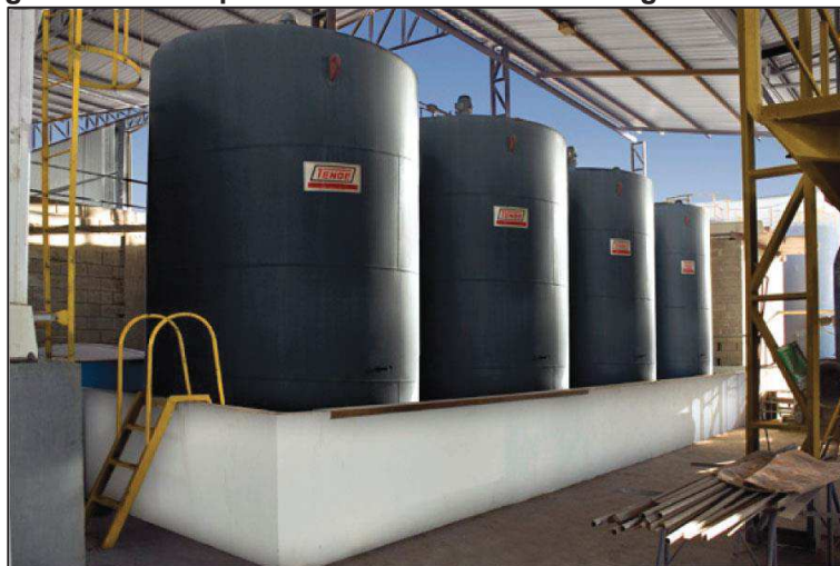
Figura 29 — Tanques de armazenamento dos ligantes asfálticos
