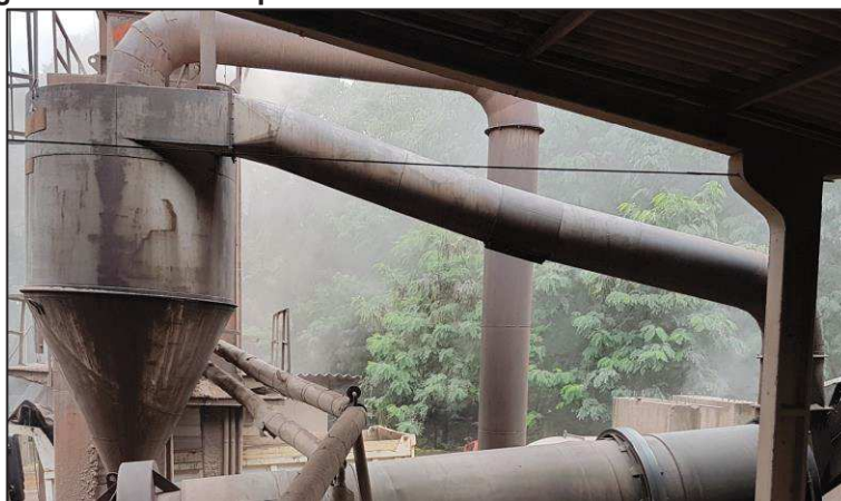
Figura 40 — Coletor primário da Usina de Asfalto de Toledo – PR
