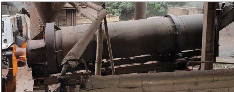
Figura 39 — Secador de contra fluxo da Usina de Asfalto de Toledo – PR
