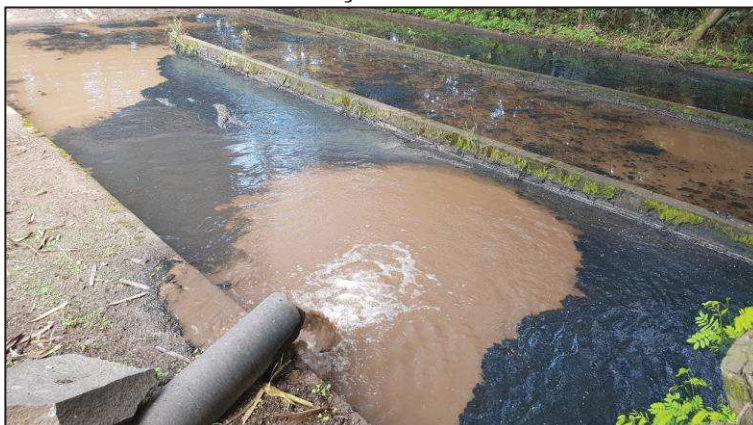
Figura 42 — Piscinas de decantação da Usina de Asfalto de Toledo – PR
