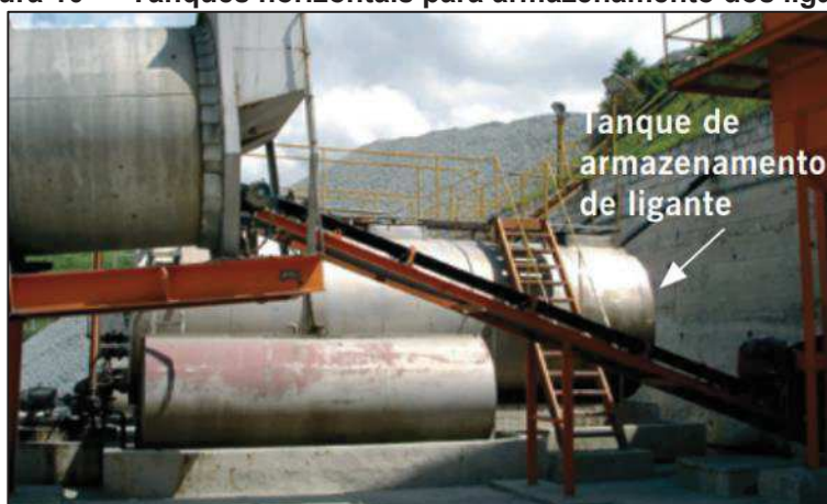
Figura 10 — Tanques horizontais para armazenamento dos ligantes
