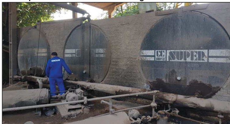
Figura 32 — Tanques de armazenamento do ligante asfáltico e xisto betuminoso
