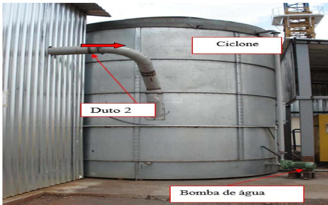
Figura 22 - Exaustão do duto de retorno da granalha utilizada no jato
