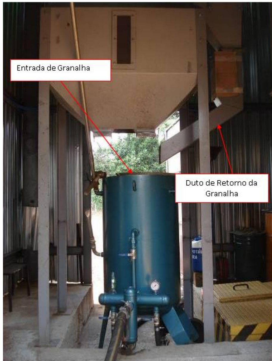
Figura 12 - Câmara de granalha.
