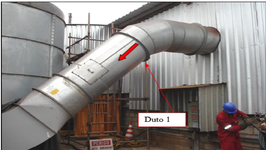
Figura 20 - Exaustão Câmara de Jato
