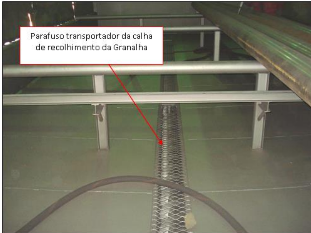
Figura 13 - Interior da câmara de jato
