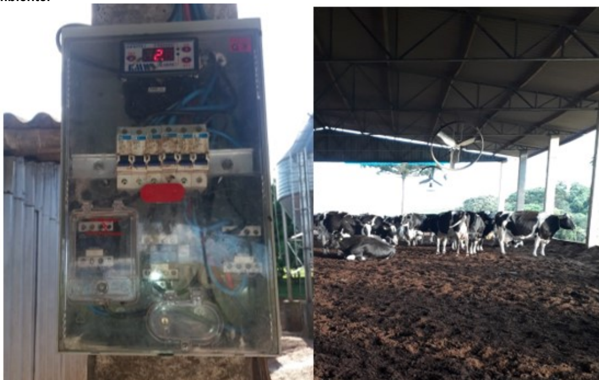
Figura 4 – Sistema de acionamento automático dos ventiladores conforme temperatura ambiente.
