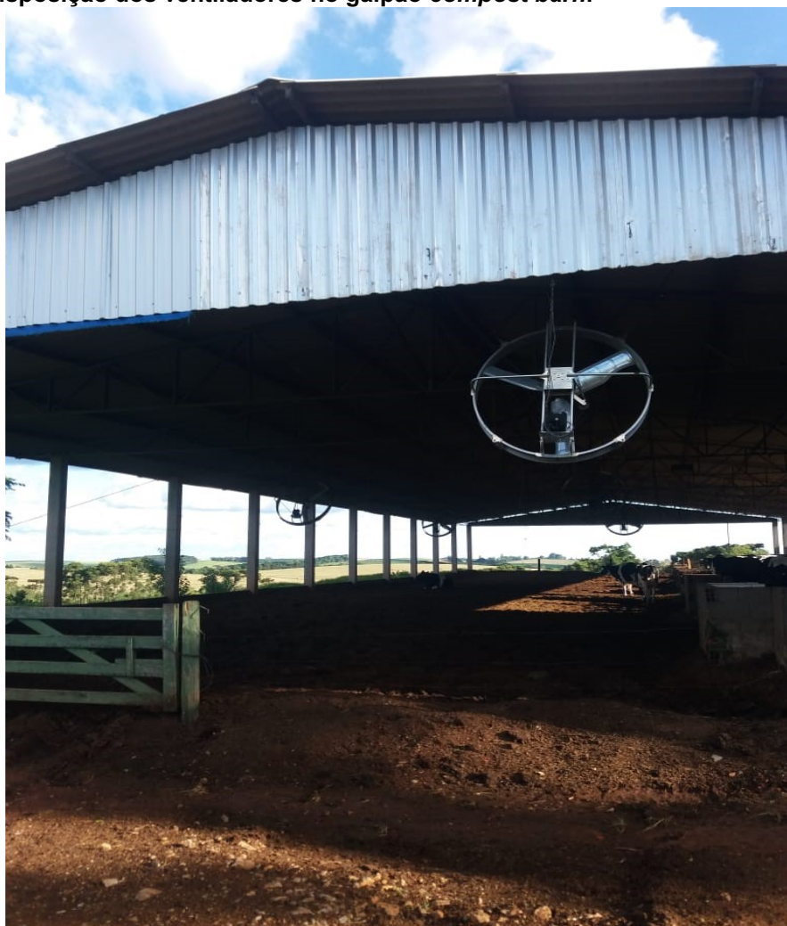
Figura 3 – Disposição dos ventiladores no galpão compost barn .
