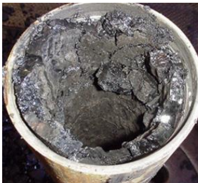
Figura 1.2 - Tubulação com o diâmetro reduzido devido à deposição de parafina.
