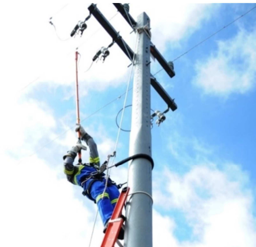
Figura 6 - Fechamento dos GLVs, substituição de elo fusível e fechamento das seccionadoras fusíveis.
