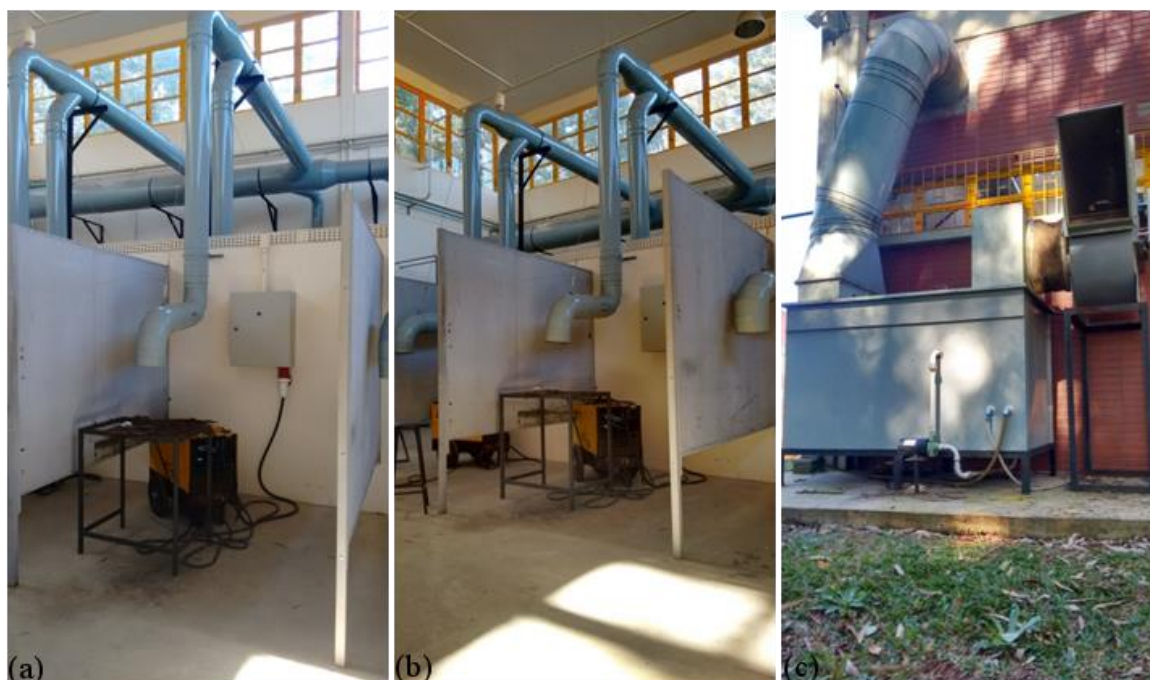
Figura 1 – Laboratório de soldagem com sistema de ventilação local exaustora: (a) estação de soldagem com captor; (b) conjunto de estações soldagem e rede de dutos; (c) coletor de contaminantes e exaustor
