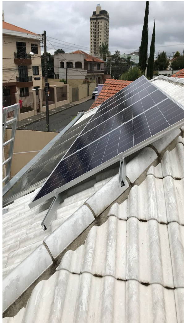
Figura 3 – Módulos fotovoltaicos instalados
