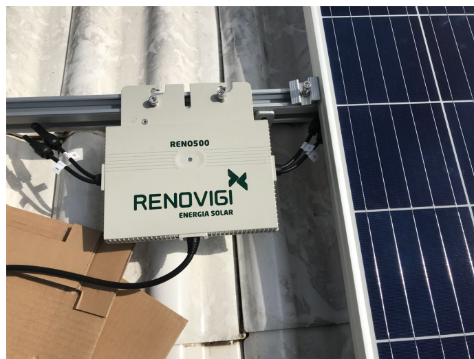
Figura 4 – Microinversor instalado junto aos painéis fotovoltaicos.
