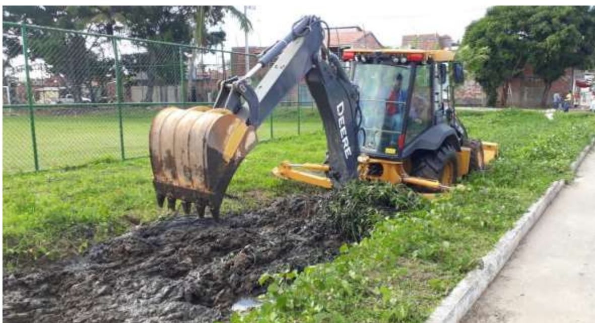
Figura 7. Limpeza de canais de drenagem realizada pela prefeitura no município de Camaçari. Fonte: SEINFRA/PMC (CAMAÇARI, 2017).
