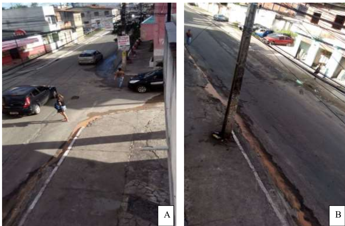
Figura 12 (A e B). Flagrantes da rede de drenagem mostrando problemas no município de Camaçari.
