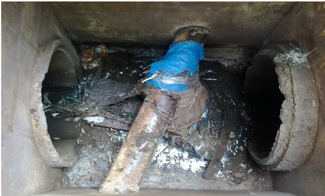
Figura 7 – Tubulação de Esgoto Cruzando a Galeria Pluvial na Av. Juscelino Kubitschek Fonte: PMFI, 2013.
