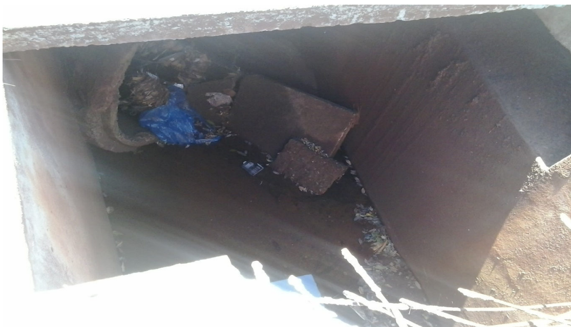
Figura 6 – Resíduos Sólidos em Bueiro na Av. Juscelino Kubitschek Fonte: PMFI, 2013
