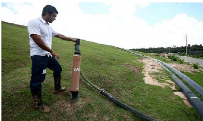
Figura 7 – Tubo vertical coletor e tubulação transportadora de gases Fonte: Foto de Carol Garcia/AGECOM (2014).
