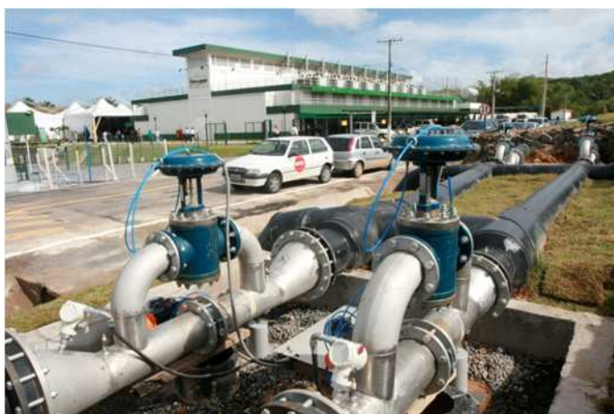
Figura 8 – Registros e válvulas de gases Fonte: Foto de Rafael Martins/AGECOM (2014).
