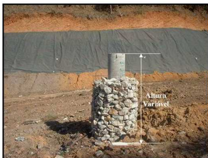
Figura 6 – Dreno de Gás do Aterro Fonte: CTR Nova Iguaçu (2003).
