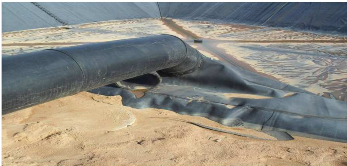
Figura 4 – Conexão da bacia de chorume Fonte: A autora (2012).
