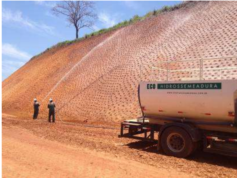
Figura 6 – Hidrosseadura Aplicada em um Talude de Corte cuja Superfície Já Possui as Covas Implantadas Fonte: Eco Gestão Ambiental (2018).
