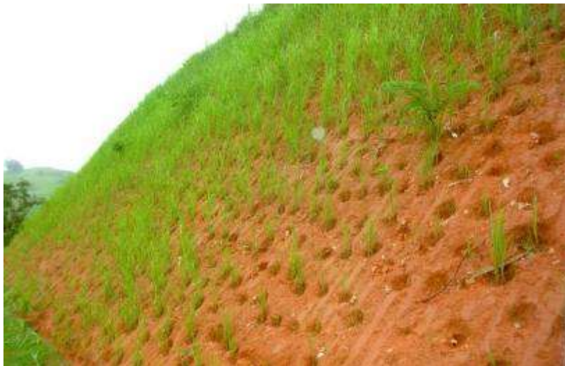
Figura 7 – Talude de Corte Quinze Dias Após Aplicação da Hidrosseadura Fonte: Eco Gestão Ambiental (2018).
