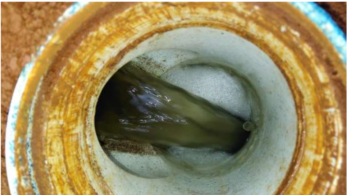
Figura 9 - Saída de Esgoto do Reator Anaeróbio/Entrada Filtro Anaeróbio (UASB) Fonte: Própria
