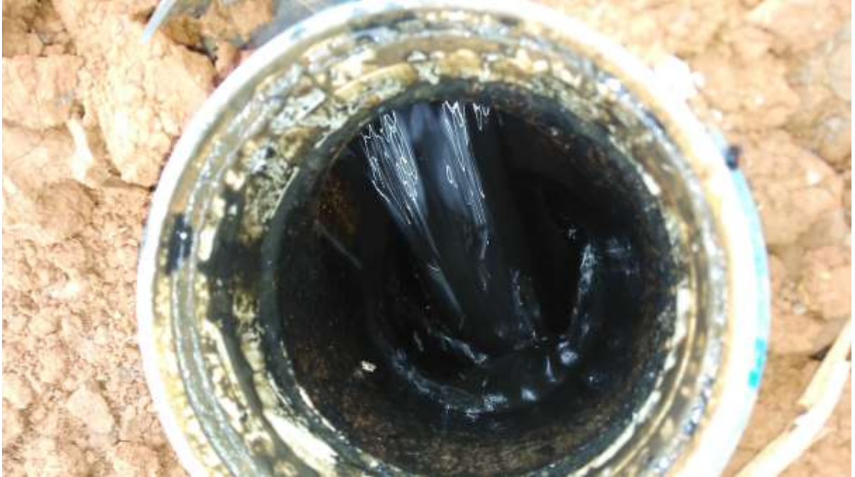
Figura 8 - Entrada de Esgoto no Reator Anaeróbio (UASB) Fonte: Própria
