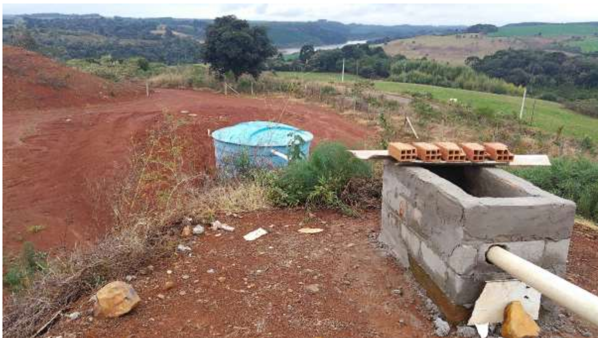
Figura 4 - Imagem da ETE instalada Fonte: Própria
