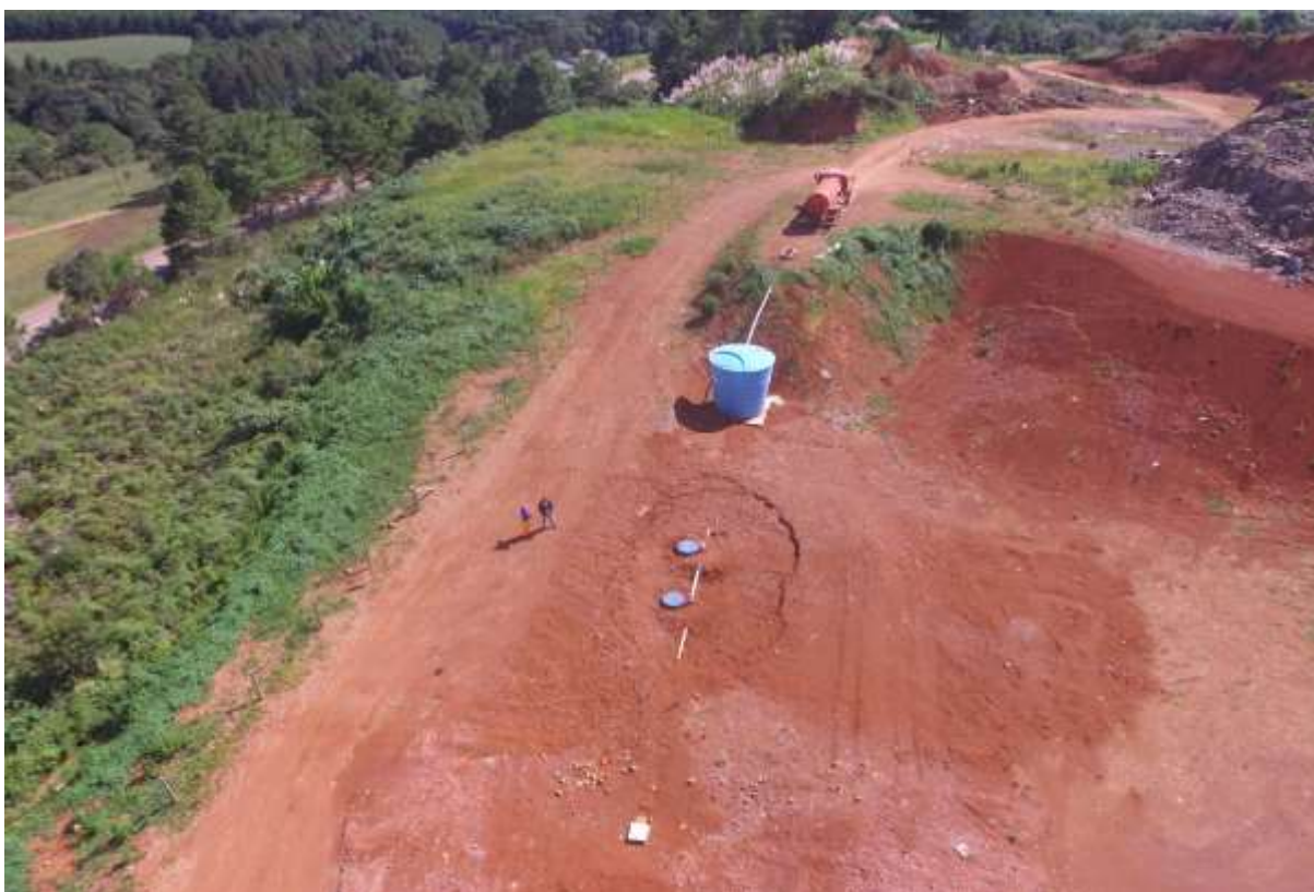
Figura 3 - Imagem Aérea da ETE Instalada (Janeiro/2018) Fonte: Própria
