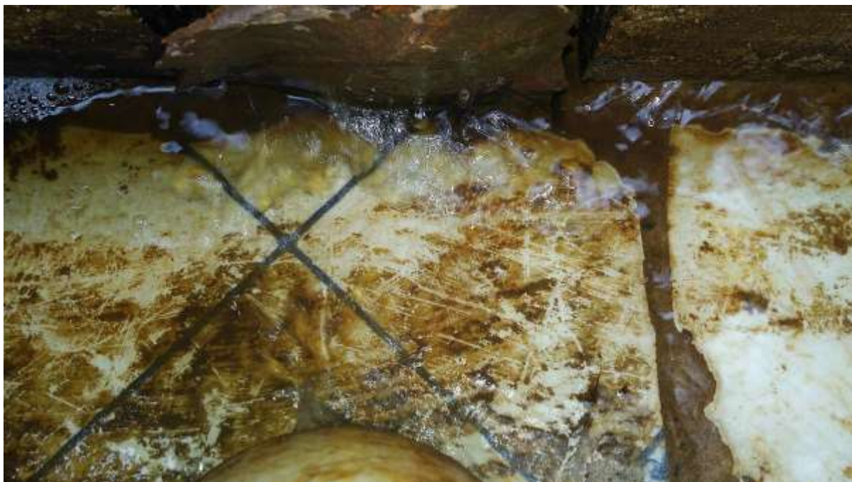
Figura 10 - Saída de Esgoto do Filtro Anaeróbio/Entrada do Sumidouro Fonte: Própria
