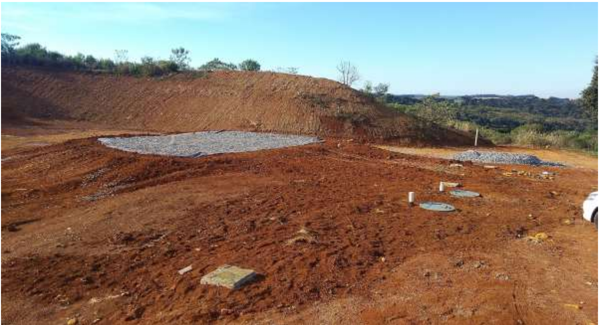
Figura 200 – Lagoa Wetlands Instalada e Com Meio Filtrante Fonte: Própria
