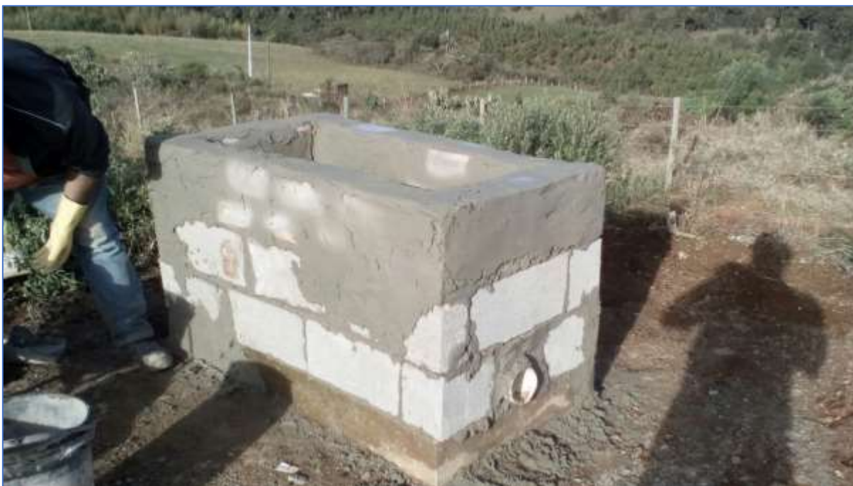
Figura 5 - Tratamento Preliminar Instalado (dezembro/2017) Fonte: Município de Monte Carlo - SC
