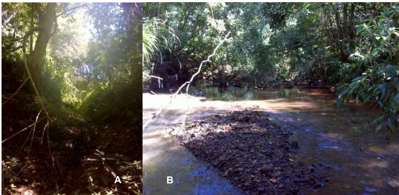
Figura 12. (A) Ponto de Lançamento de um Canal de Drenagem de Água Pluvial e; (B) Assoreamento da Calha do Rio Cascavel.
