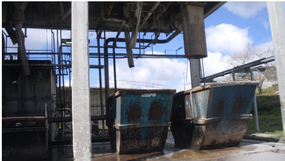
Figura 8: Caçambas condicionadoras de lodo seco retirado das Centrifugas
