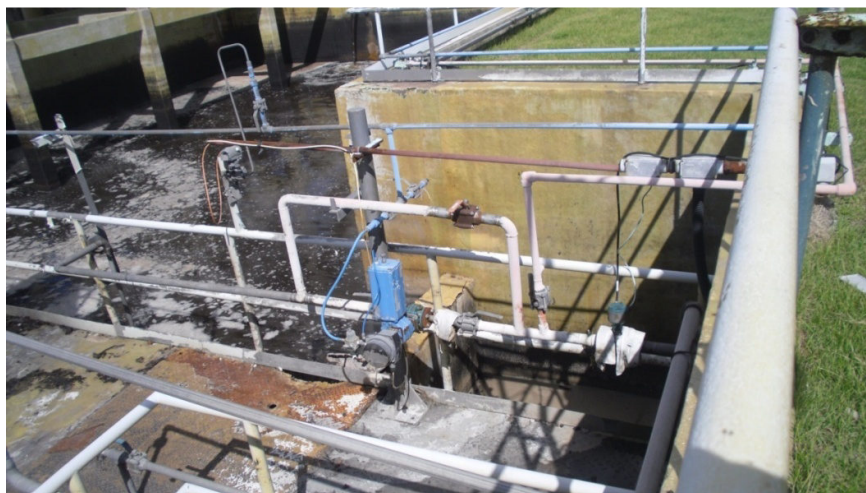
Figura 6: Sistema de neutralização do efluente na entrada da ETE
