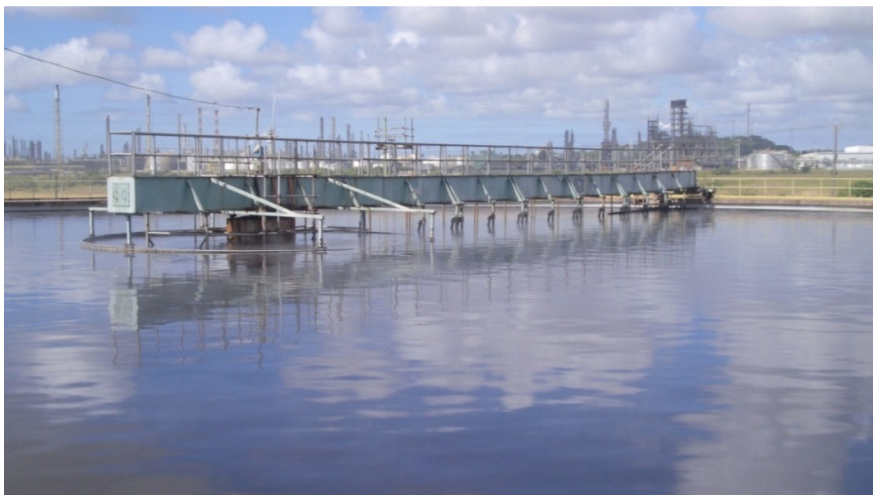
Figura 5: Ponte removedora de lodo da BSC
