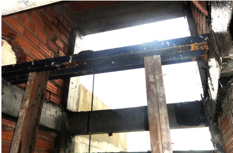
Fotografia 9: Viga superior de sustentação do elevador
