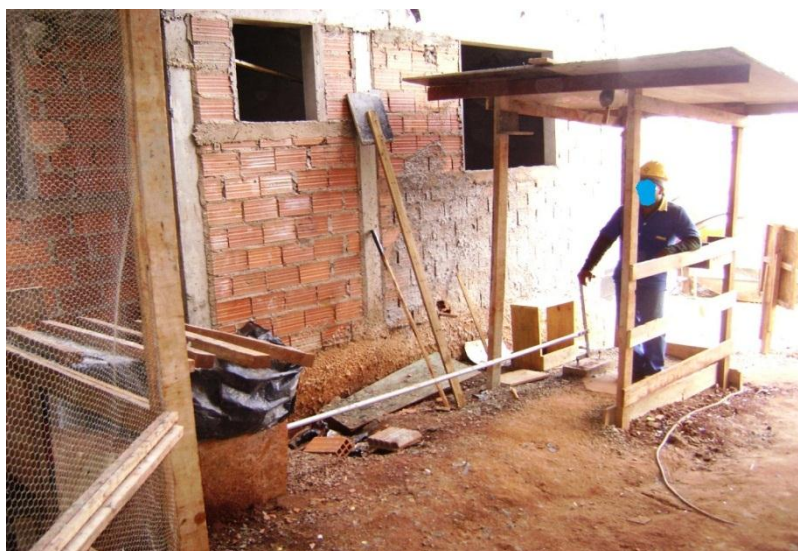
Fotografia 7: Posto de operação do guincheiro.
