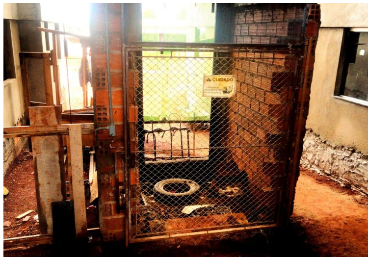
Fotografia 6: Sinalização deficiente no elevador de materiais.
