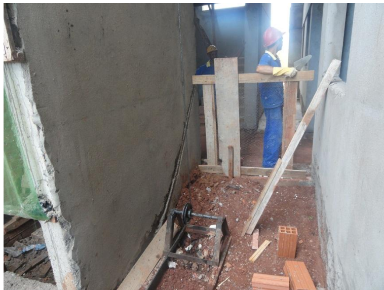
Fotografia 3: Isolamento da área entre roldana e tambor
