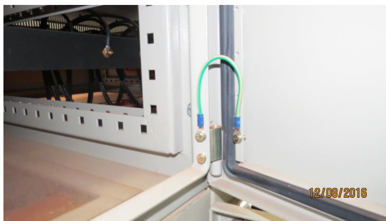
Figura 23 - Detalhe do aterramento da porta do CCM (carcaça do painel já aterrada) Fonte: O autor (2016)
