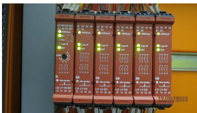
Figura 36 - Detalhe dos relés de segurança monitorando o setor de emergência Fonte: O autor (2016)
