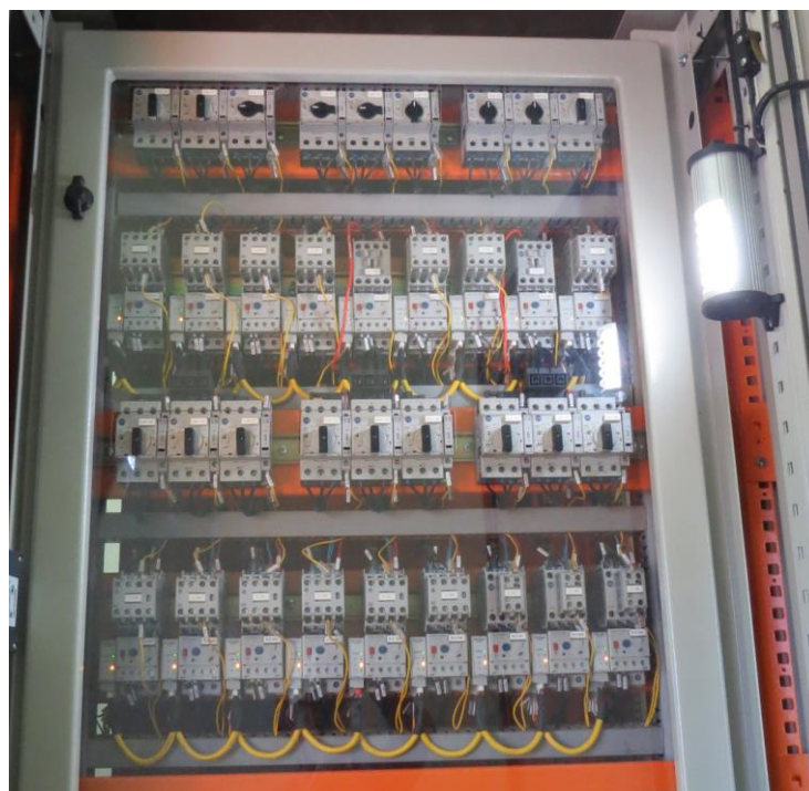
Figura 42 - CCM novo: Organização com partidas e identificação de cabos, bem como acrílico para separação dos componentes e dos barramentos Fonte: O autor (2016)
