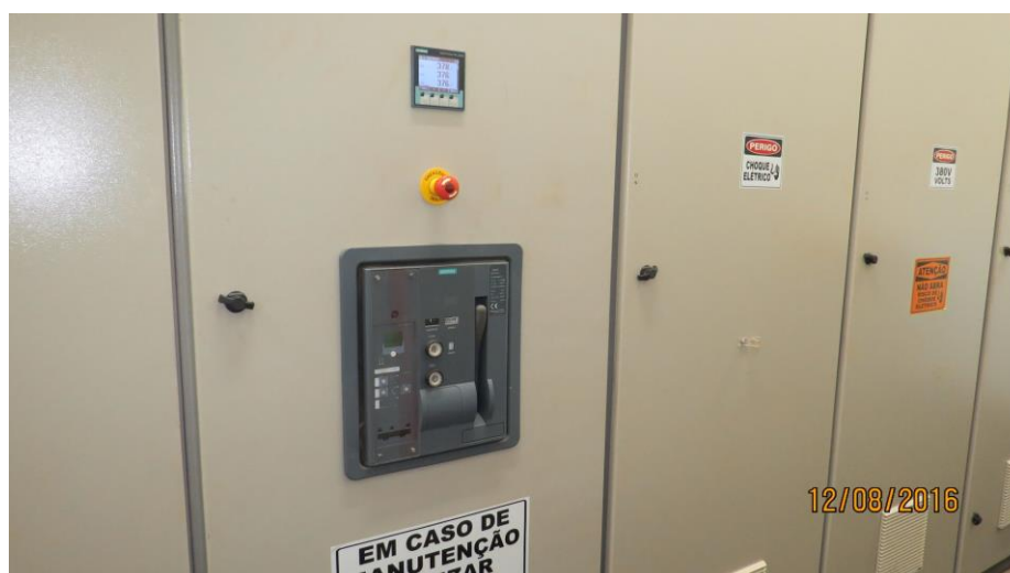
Figura 33 - Porta do CCM com emergência geral e disjuntor de proteção Fonte: O autor (2016)
