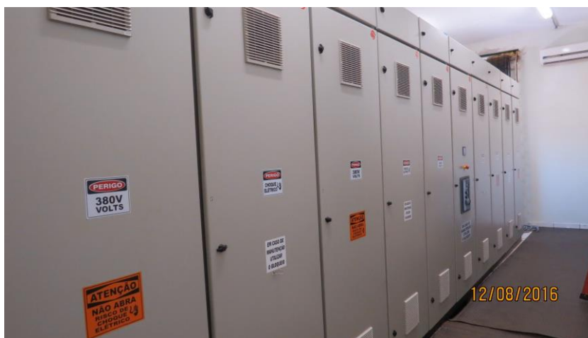
Figura 21 - Painel elétrico montado com adesivos informando o perigo Fonte: O autor (2016)
