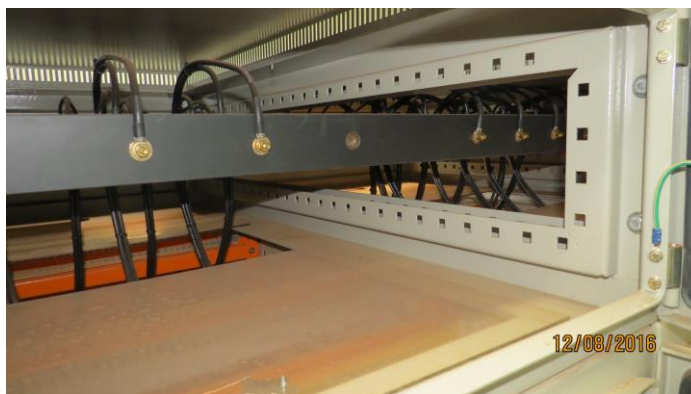
Figura 18 - Detalhe de barramento com luva termo contrátil Fonte: O autor (2016)
