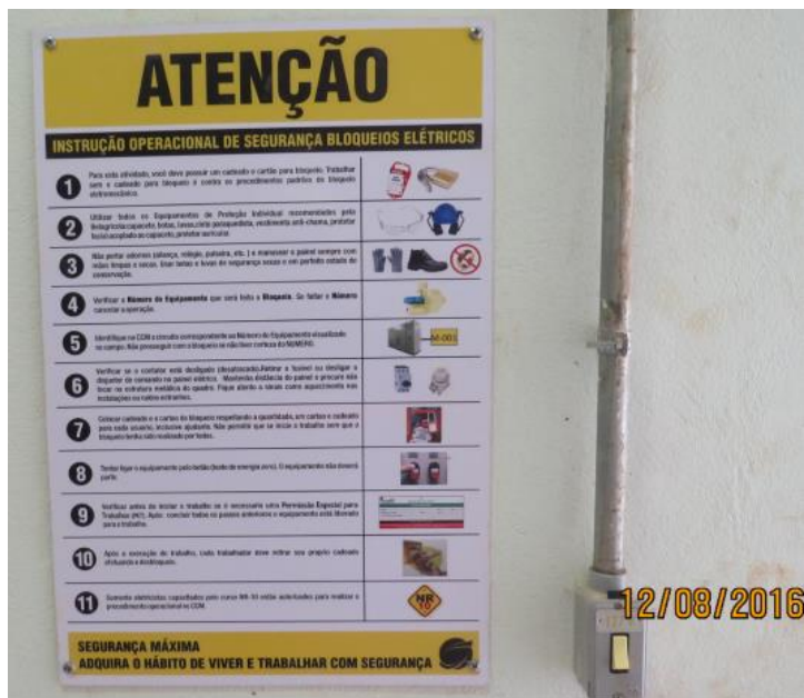
Figura 20 - Painel elétrico montado com adesivos informando o perigo Fonte: O autor (2016)
