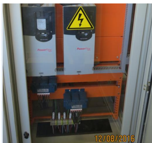
Figura 22 - Uma das portas abertas. Há a advertência de choque elétrico e os cabos anilhados Fonte: O autor (2016)
