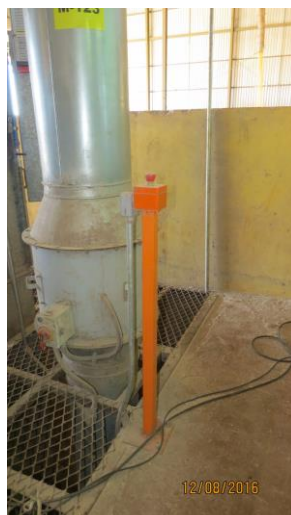
Figura 32 - Outro botão de emergência setorial Fonte: O autor (2016)
