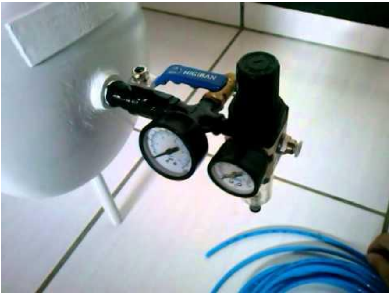
Figura 6 - Exemplo de pressostato em vaso de pressão
