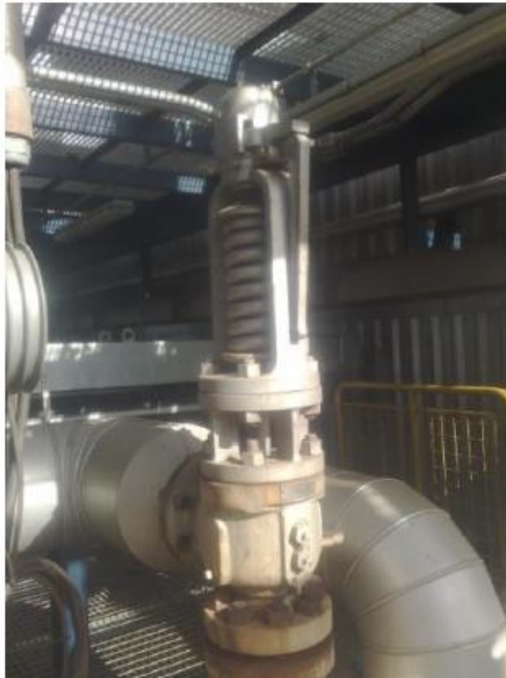
Figura 4 - Válvula de segurança instalada em caldeira
