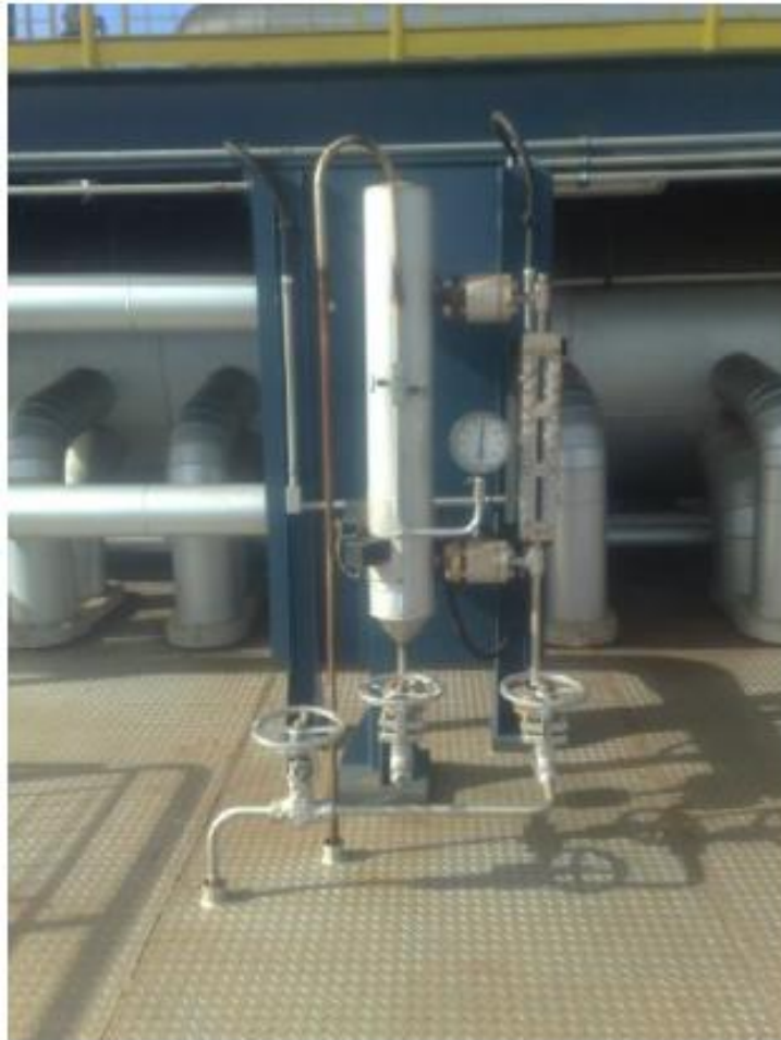
Figura 5 - Instrumentos de controle de caldeira
