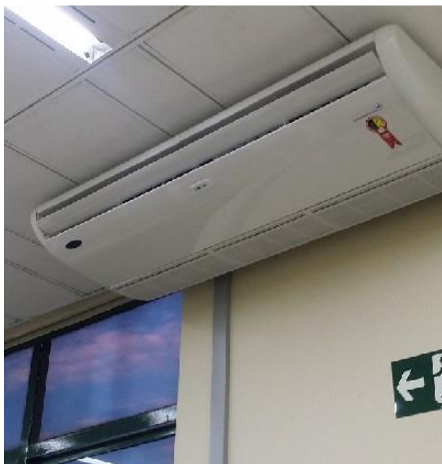
Figura 3 – Foto do ar condicionado na sala 01 Fonte: Autoria Própria (2017)
