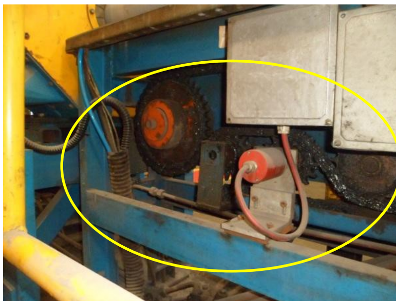
Fotografia 12 – Alimentador Automático de Tarugos de Alumínio: Engrenagens Expostas
