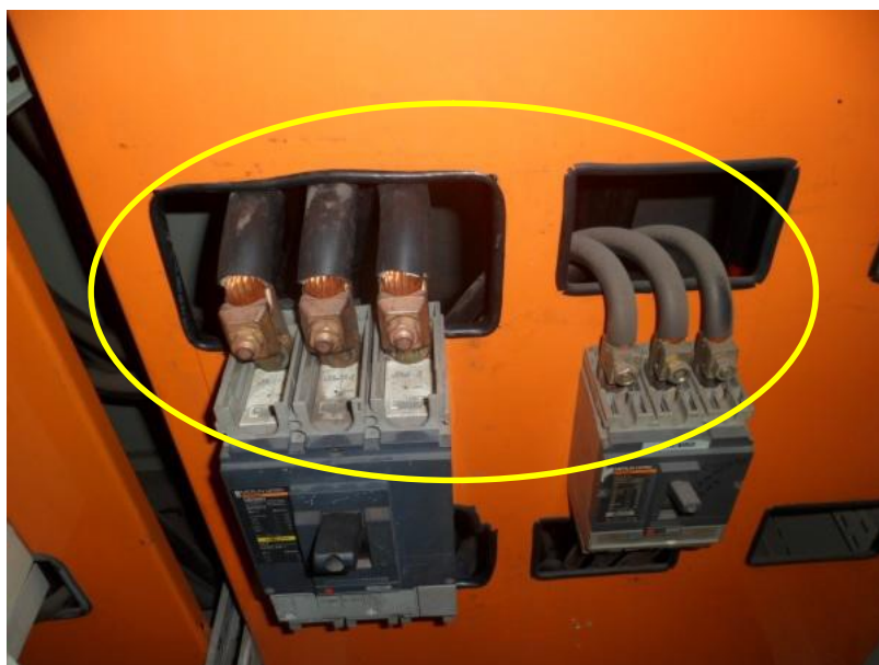
Fotografia 20 – Painéis de Alimentação com Partes Energizadas Expostas (B)
