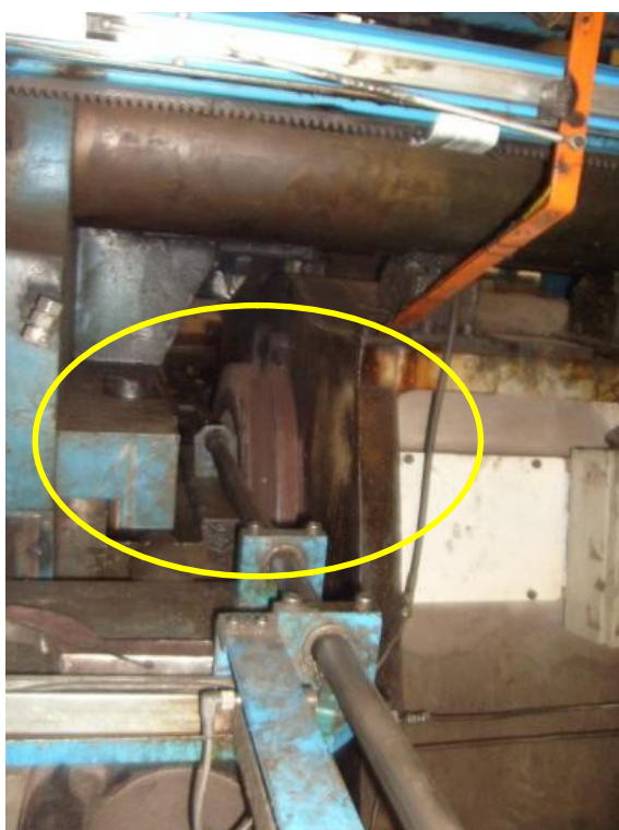
Fotografia 16 – Área de Prensagem: Partes Móveis-Cilindros Hidráulicos Expostos (B)
