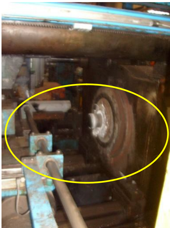
Fotografia 15 – Área de Prensagem: Partes Móveis-Cilindros Hidráulicos Expostos (A)
