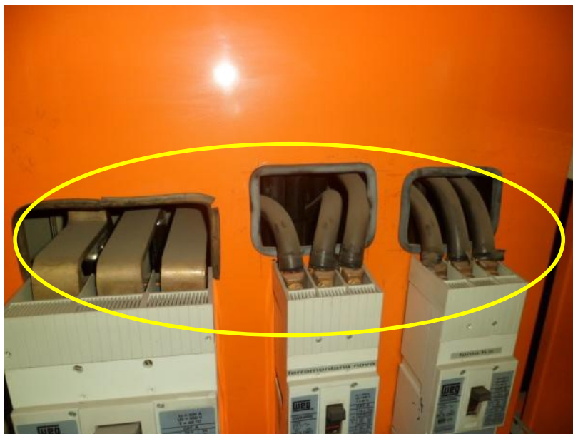
Fotografia 19 – Painéis de Alimentação com Partes Energizadas Expostas (A)
