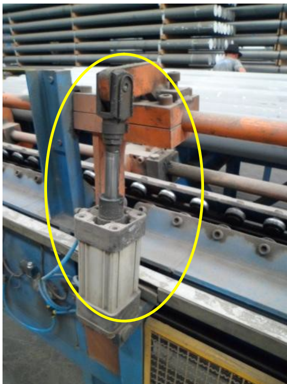
Fotografia 9 – Alimentador Automático de Tarugos de Alumínio: Pistão
