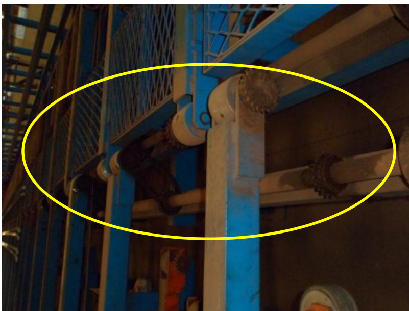
Fotografia 42 – Vista Lateral da Plataforma de Apoio de Perfis: Zona de Risco e Partes Expostas (D)
