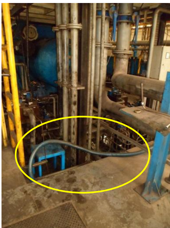
Fotografia 24 – Parte Traseira do Conjunto Prensa: Partes Móveis Expostas
