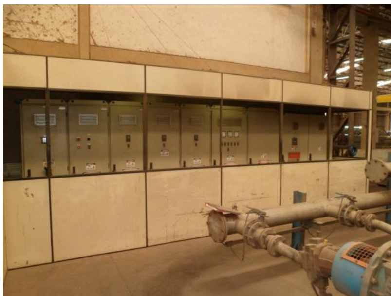
Fotografia 18 – Dispositivos de Parada de Emergência (B)
