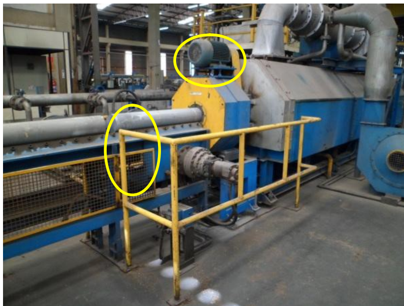
Fotografia 13 – Lateral e Saída do Forno de Aquecimento de Tarugos de Alumínio e Motor Auxiliar
