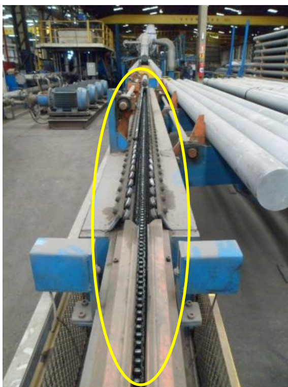
Fotografia 10 – Alimentador Automático de Tarugos de Alumínio: Correntes Expostas
