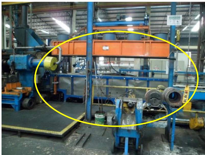
Fotografia 7 – Lateral Esquerda do Conjunto Prensa Extrusora: Acesso Direto a Zona de Risco
