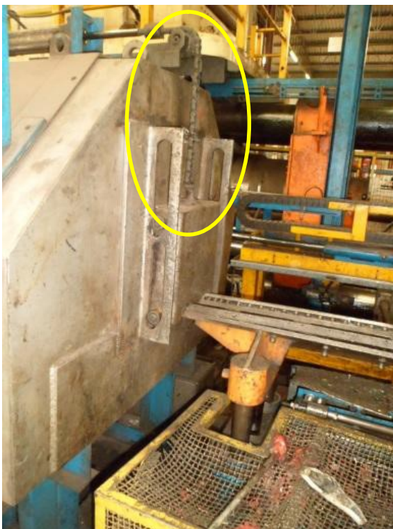
Fotografia 43 – Engrenagem e Corrente Forno de Aquecimento de Tarugos
