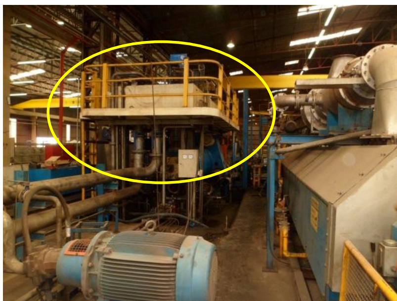
Fotografia 26 – Parte Traseira Do Conjunto Prensa: Zona de Risco e Proteções Fixas
