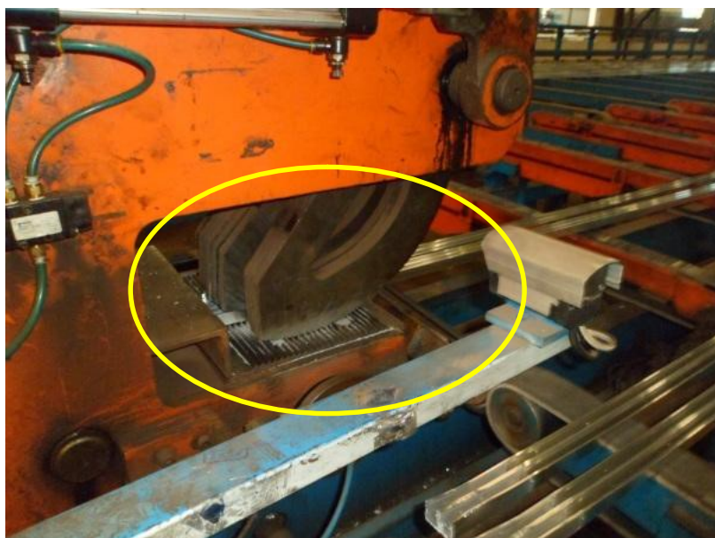
Fotografia 36 – Esticador de Perfis: Partes Móveis Expostas: Detalhe Interno
