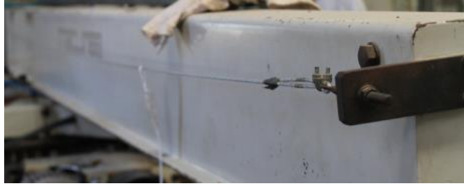
Fotografia 11- Cabo de parada de emergência atual
