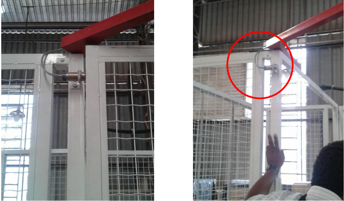
Fotografia 5- Sensor magnético de proteção na porta de acesso a máquina.
