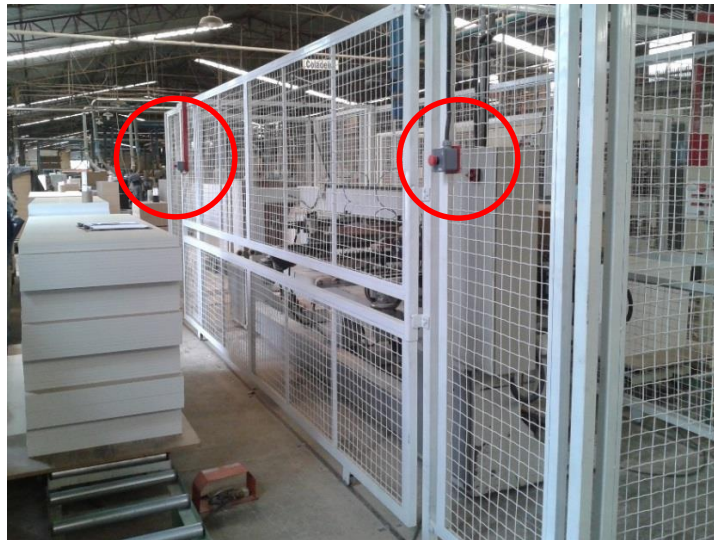
Fotografia 10 - Dispositivo de emergência no entorno da furadeira múltipla ao alcance do operador.
