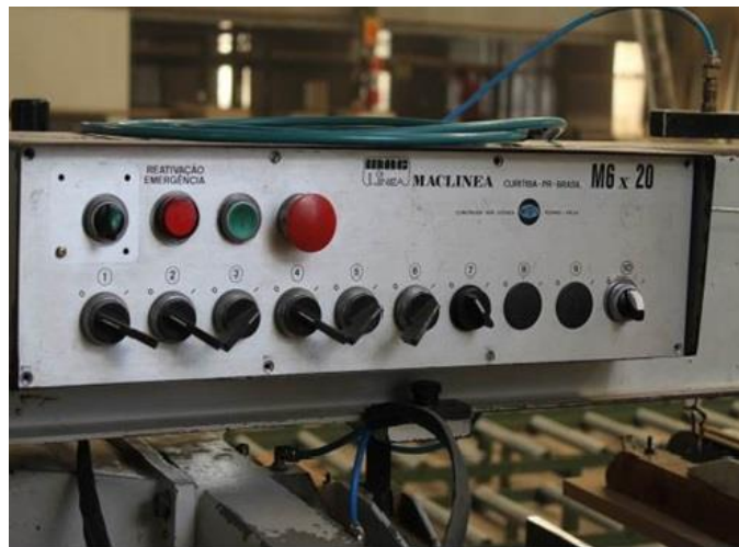
Fotografia 3 - Painel de controle furadeira múltipla Mac Linea M6X20
