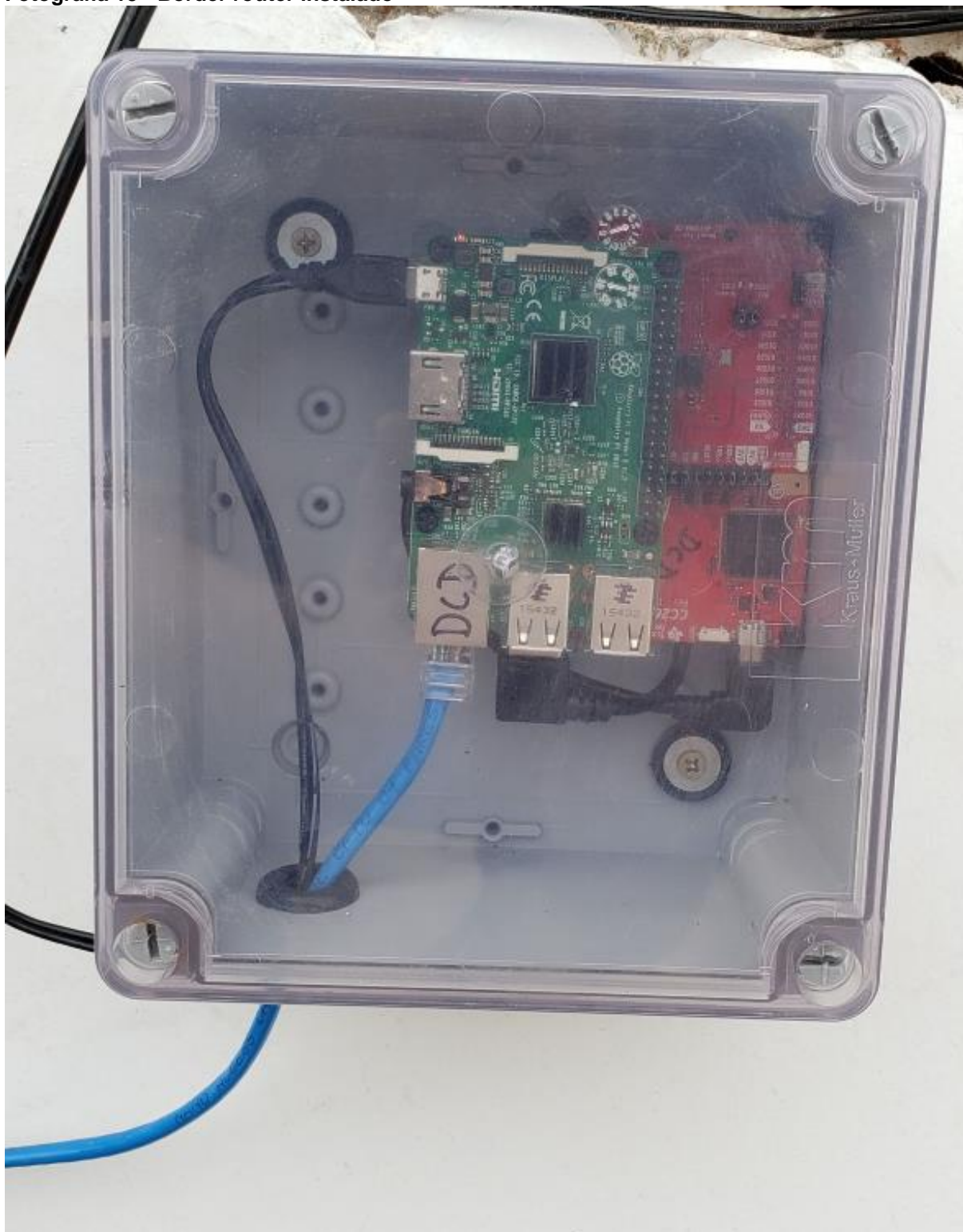
Fotografia 15 - Border router instalado
