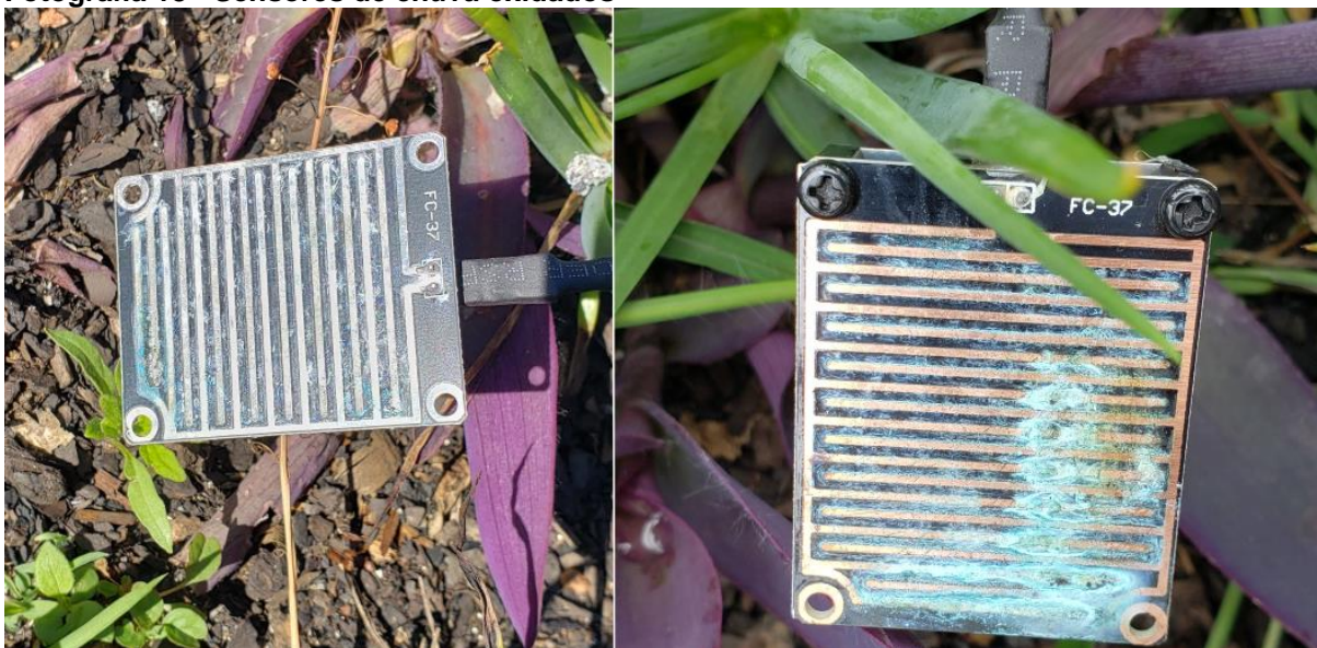
Fotografia 18 - Sensores de chuva oxidados
