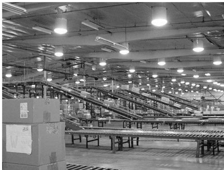
Figura 12: Sistema de iluminação tubular natural
