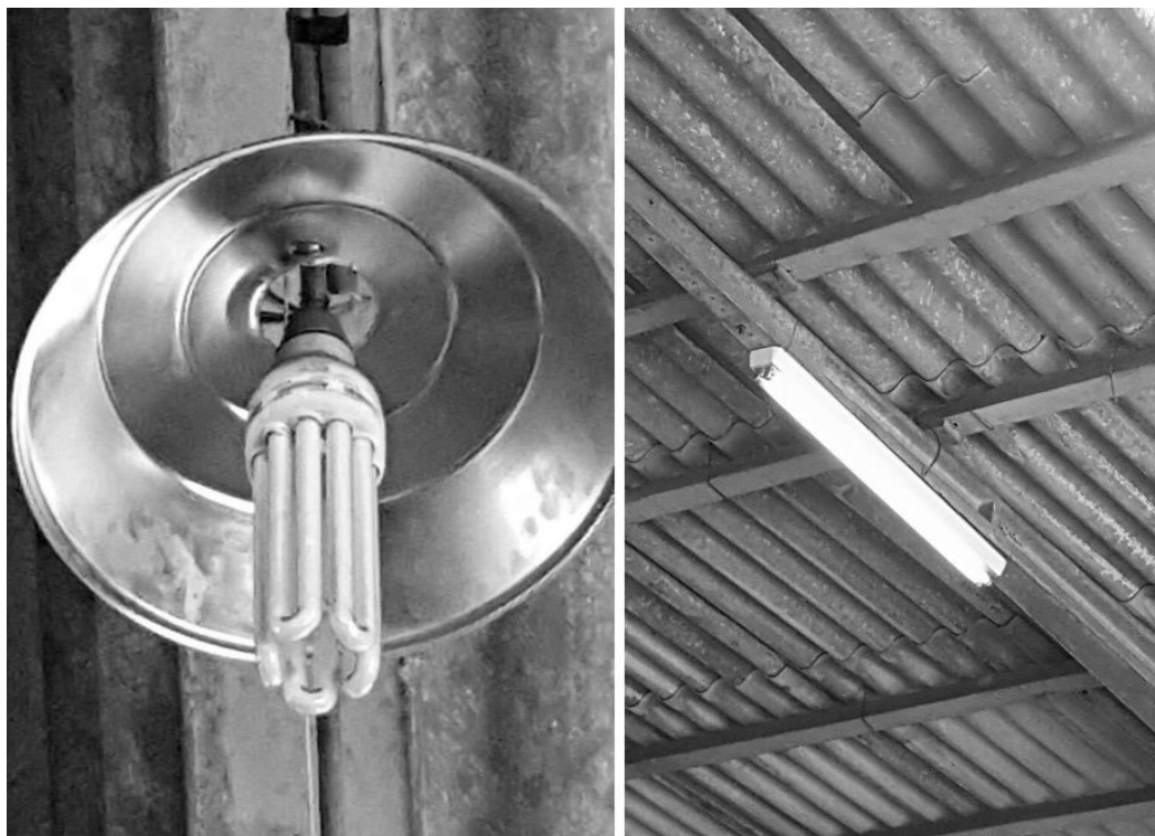
Figura 10: Luminárias instaladas no galpão
