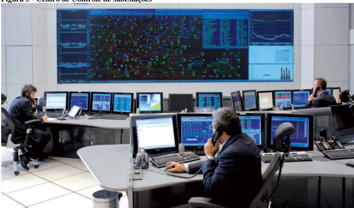
Figura 3 - Centro de Controle de subestações
