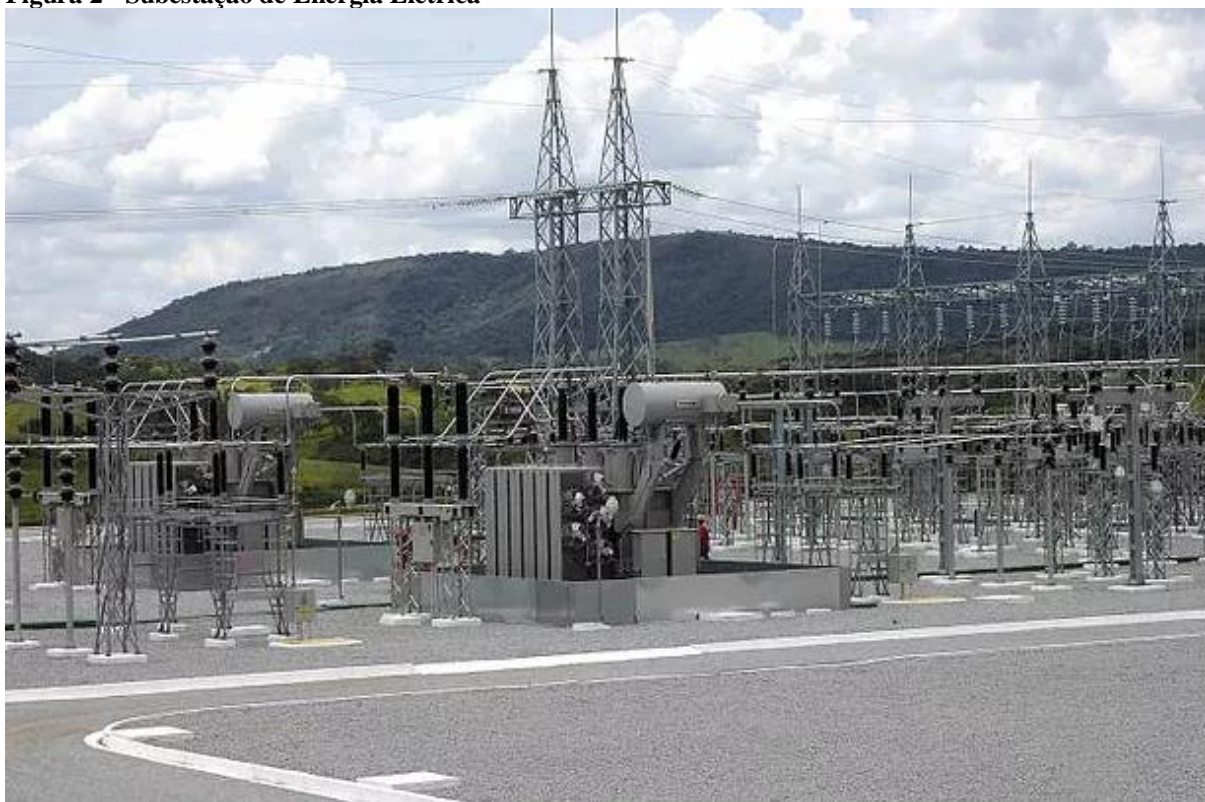
Figura 2 - Subestação de Energia Elétrica
