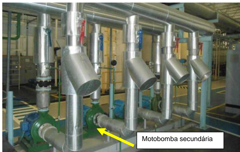
Figura 14 – Sistema de bombeamento secundário Fonte: Autoria própria (2013)
