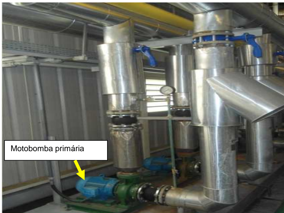
Figura 13 – Sistema de bombeamento primário Fonte: Autoria própria (2013)
