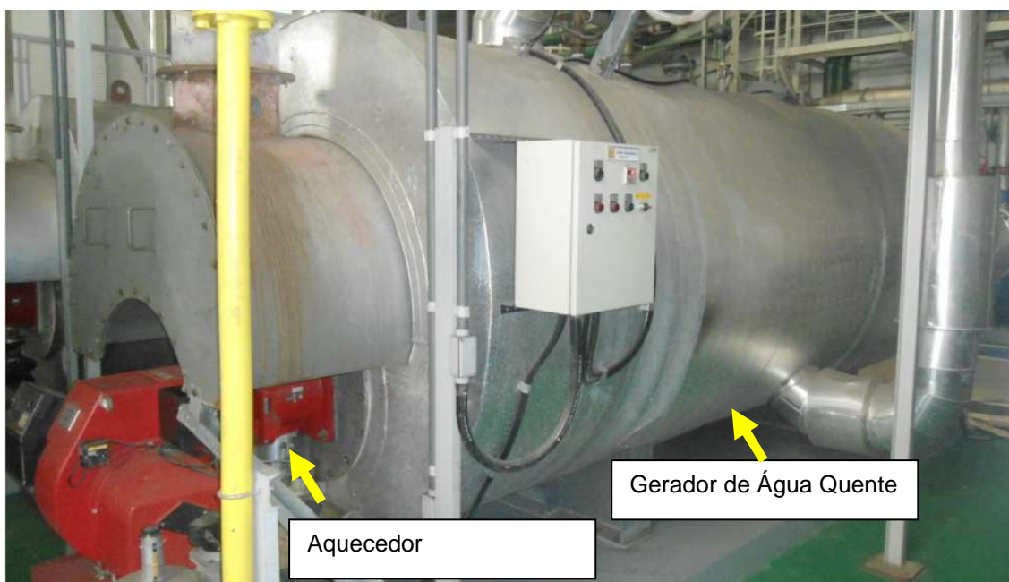
Figura 12 – Gerador de água quente Fonte: Autoria própria (2013)
