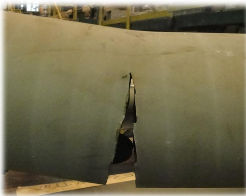
Figura 4 - Falha do rolo no tubo principal
