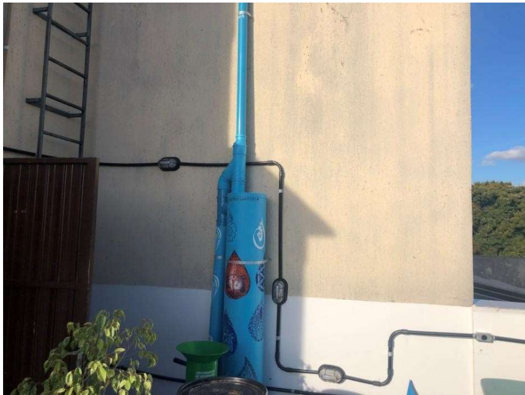
Figura 35- Cisterna instalada no terraço verde
