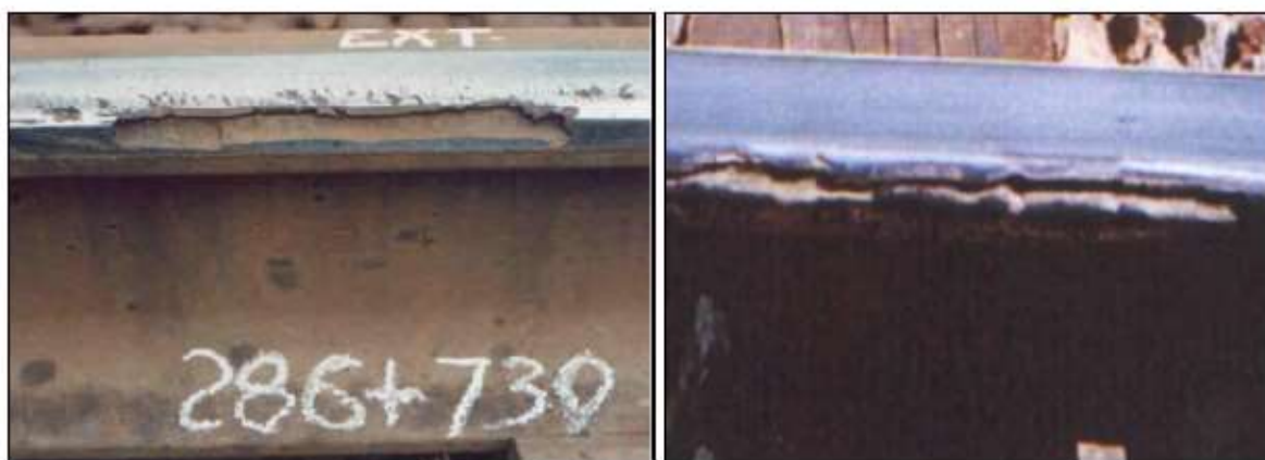
Fotografia 7 – Trinca de fragmentação
