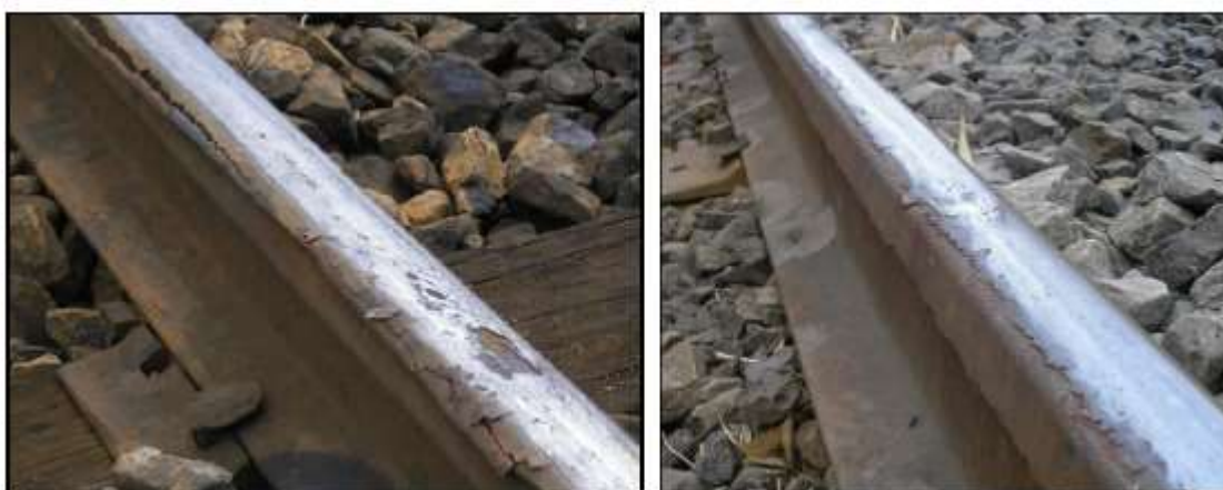
Fotografia 3 – Trinca de patinagem de roda
