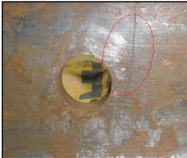
Fotografia 9 – Trinca nos furos fora da junta
