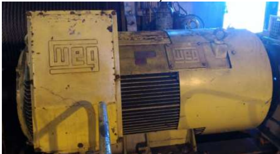
Fotografia 5 – Motor de acionamento da elevação
