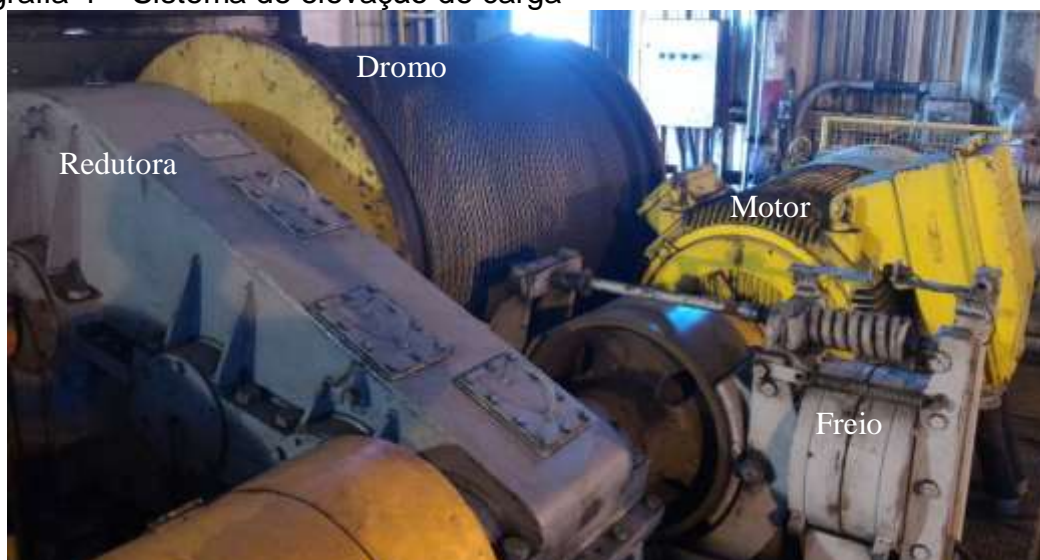
Fotografia 4 – Sistema de elevação de carga
