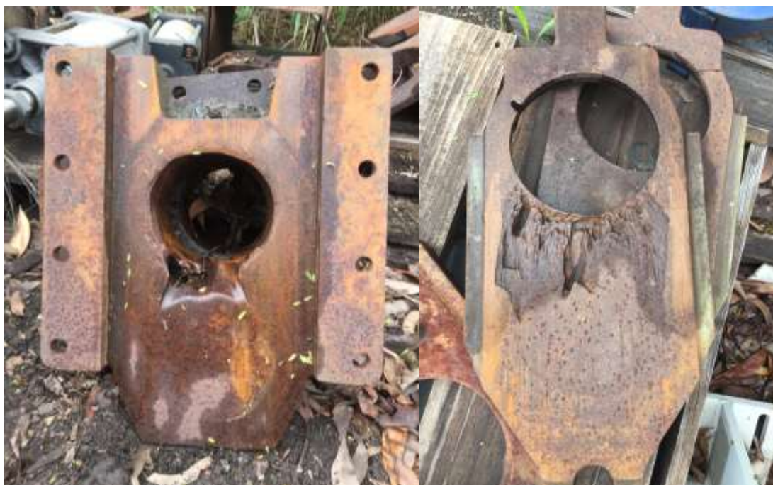
Fotografia 2.4 - Exemplos de ponto de erosão nas Válvulas AD's
