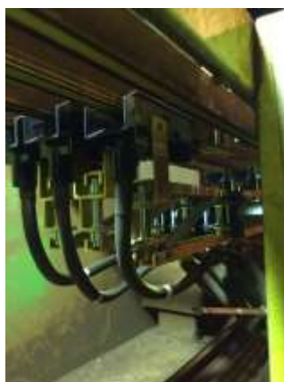
Fotografia 2.10 – Sistema de Alimentação Elétrica – Pantógrafo
