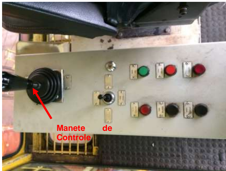
Fotografia 2.11 – Sistema de Acionamento da Ponte – Painel Controle
