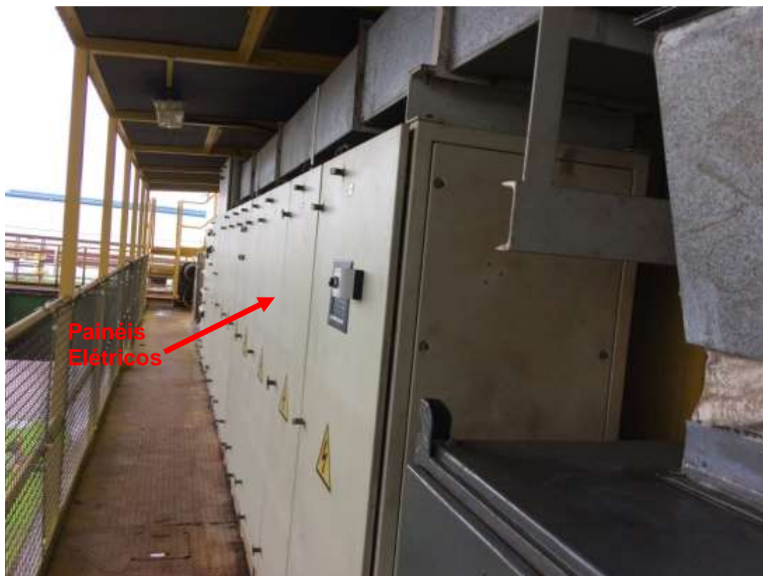
Fotografia 2.9 – Sistema de Alimentação Elétrica – Painel Elétrico
