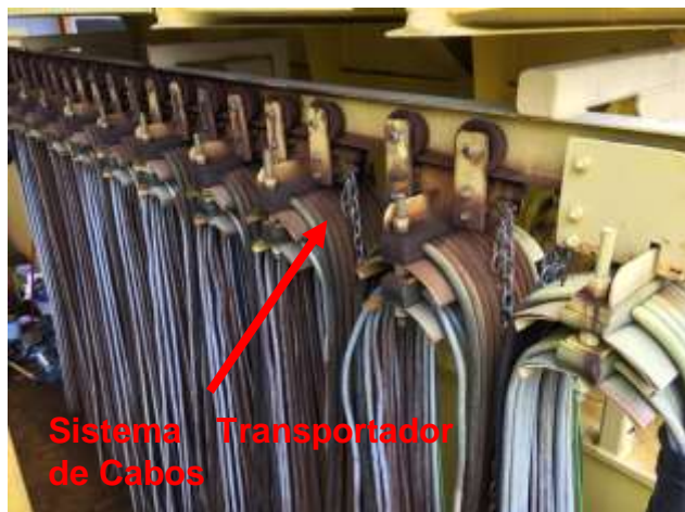
Fotografia 2.5 – Sistema de Translação do Carro – Transportador de Cabos
