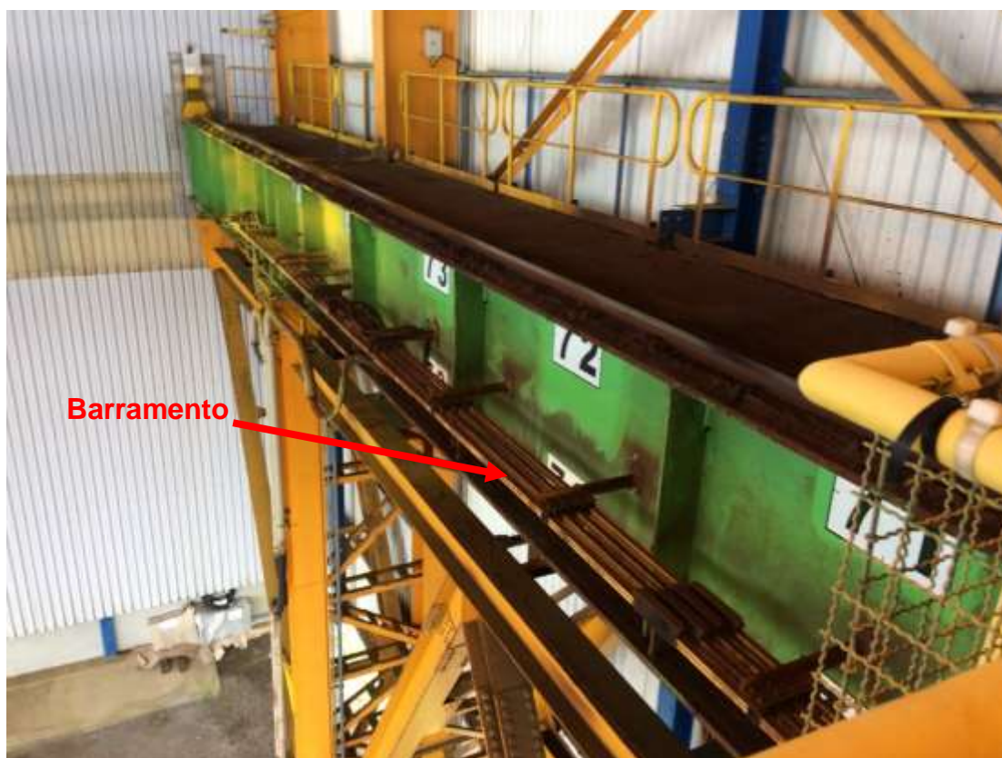
Fotografia 2.8 – Sistema de Alimentação Elétrica – Barramento
