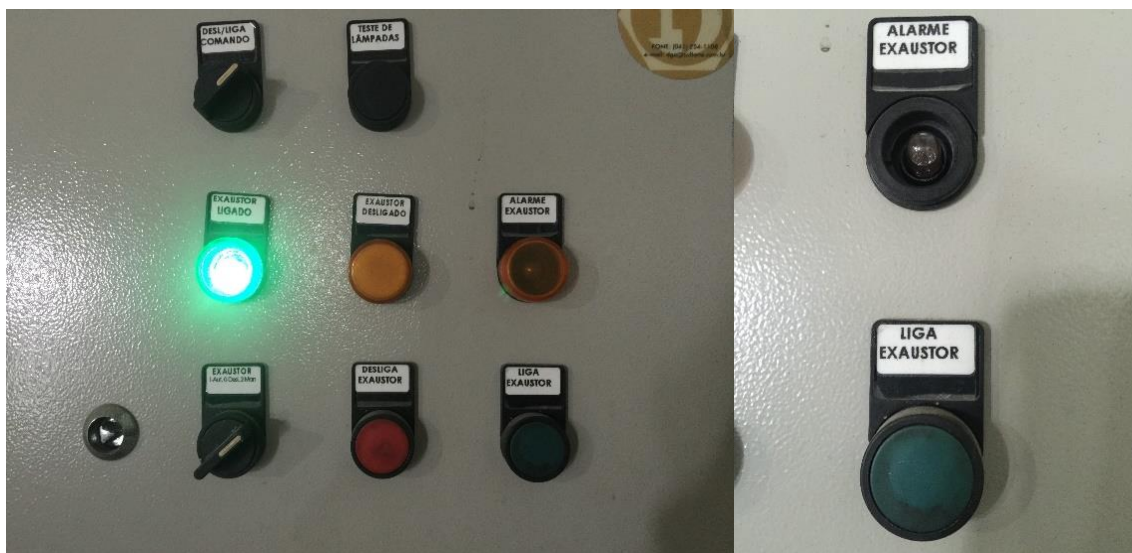
Figura 5 – Sinaleiros Incandescentes usados em painéis de exaustores Fonte: Do autor
