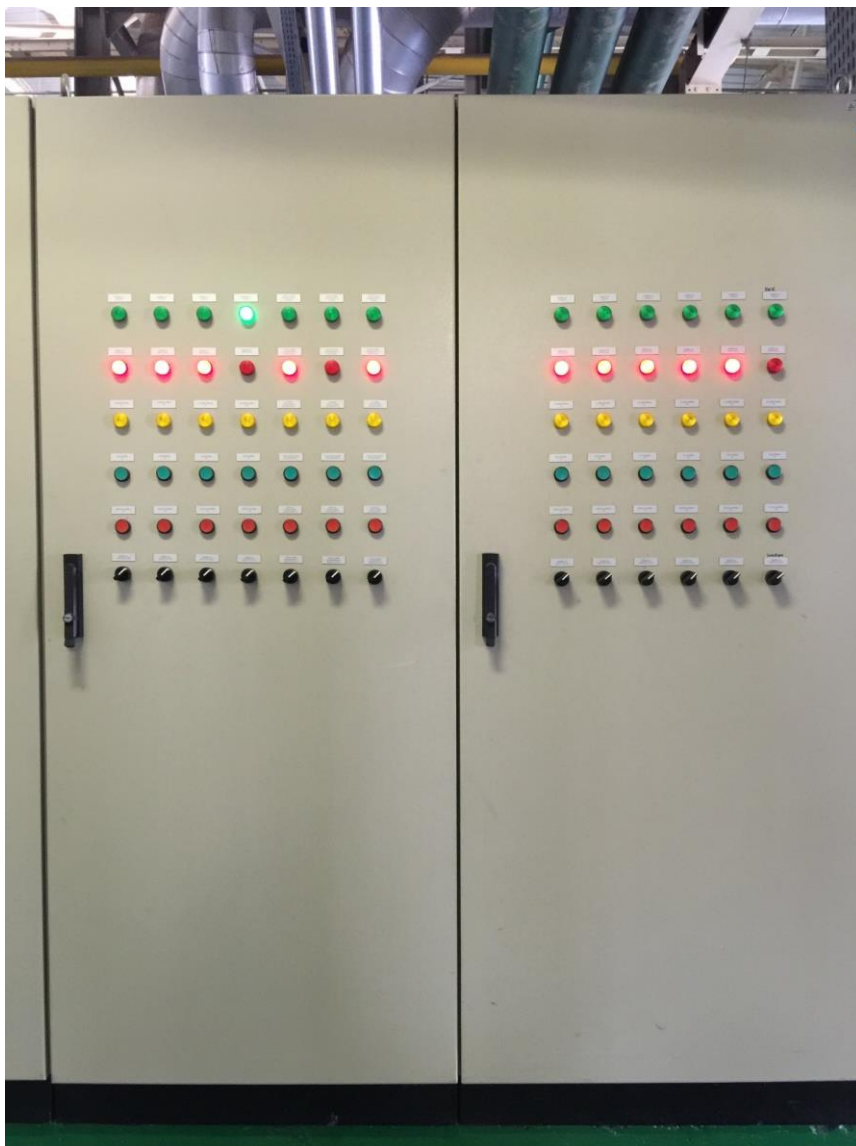
Figura 6 – Sinaleiros LED em painéis de bombas Fonte: Do autor
