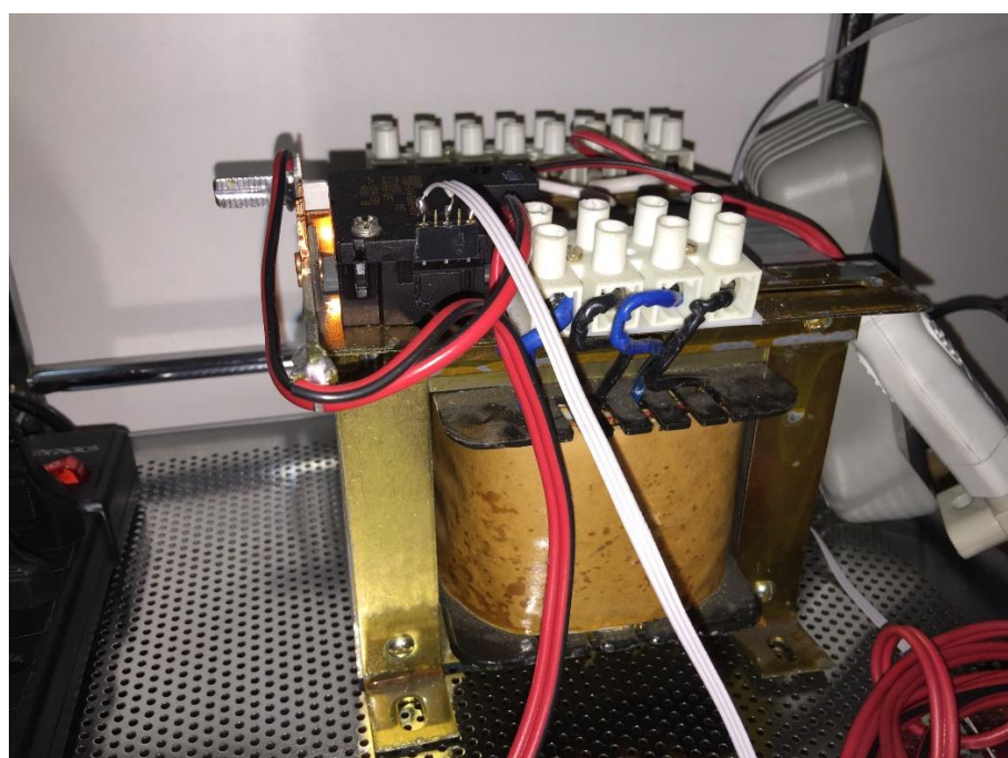
Figura 18 – Transformador Fonte: Do autor
