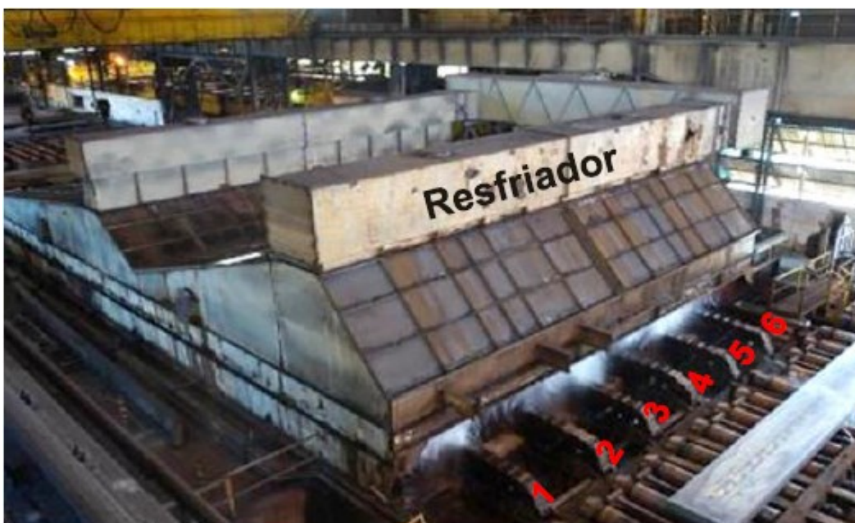
Figura 2. 5 – Vista geral do Resfriador de Placas no Condicionamento de Placa
