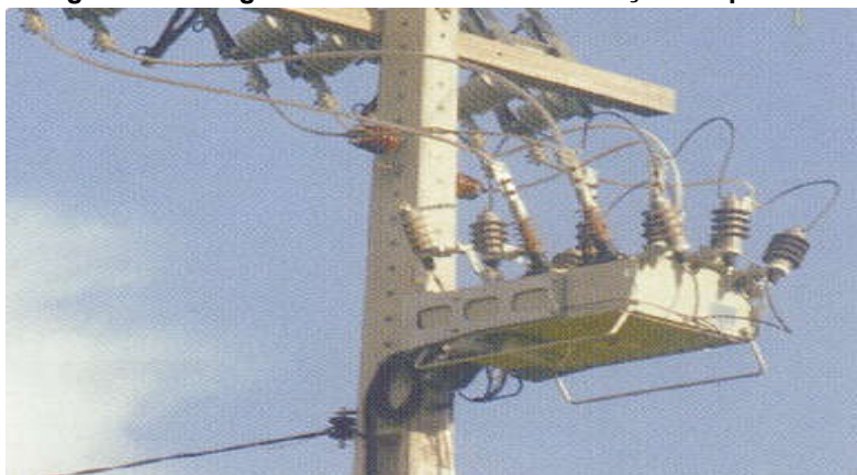
Fotografia 1 - Religador automático de distribuição em poste.
