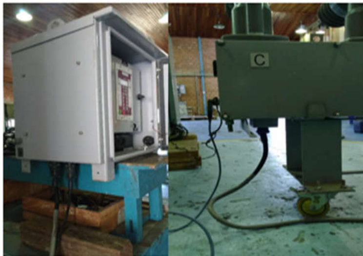
Fotografia 11 - Conexões elétricas entre o controle eletrônico e o religador Arteche.
