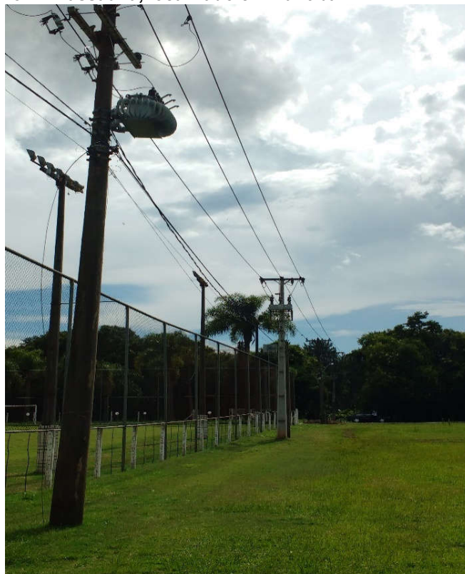
Fotografia 16 - Posto de Transformação e Rede de Baixa Tensão instalados no Al. Passaúna, localizado em Curitiba-Pr.
