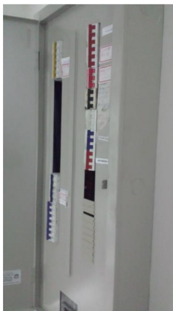
Figura 16 – Quadro geral de baixa tensão
