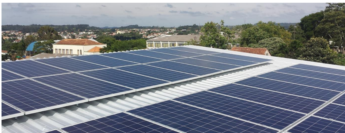
Figura 17 – Módulos fotovoltaicos instalados na cobertura
