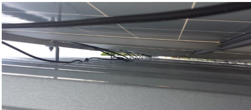
Figura 18 – Vista da parte inferior dos módulos fotovoltaicos
