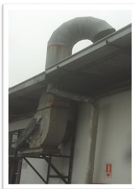
Figura 3 - Exaustor fixo com tubulação aérea. Fonte: O autor, 2018.
