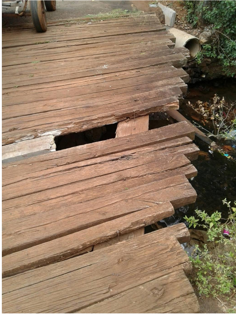
Figura 13: Ponte de acesso danificada Fonte: o Autor (2018).
