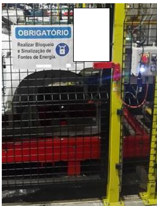
Figura 11 - Porta de acesso de manutenção Zona 3 Fonte: O AUTOR
