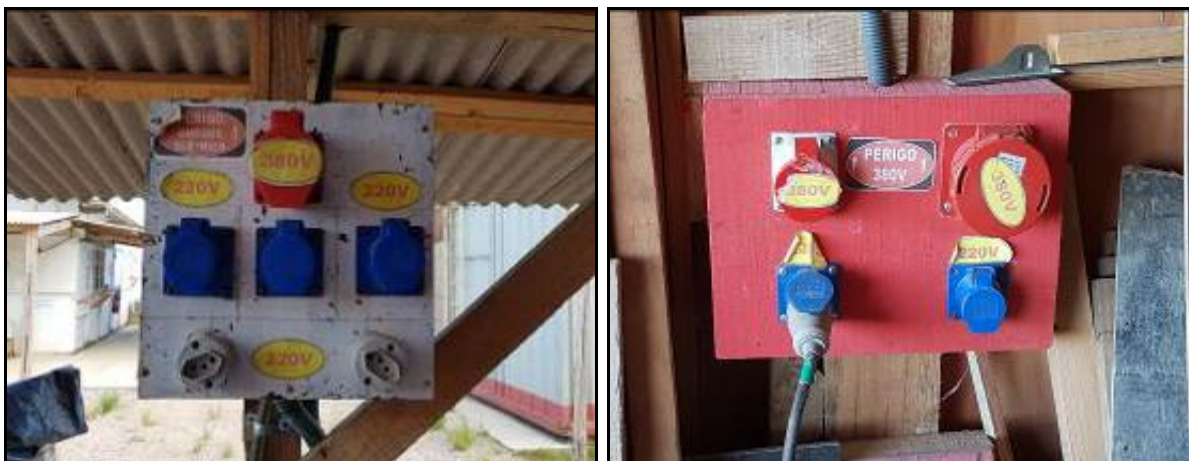
Figura 17 - Instalações Elétricas – Painéis elétricos – Obra 2
