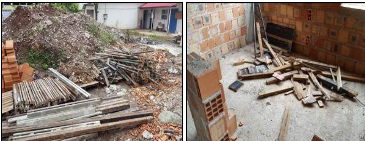
Figura 19 – Ordem e Limpeza – Armazenamento inadequado e material desorganizado – Obra 1
