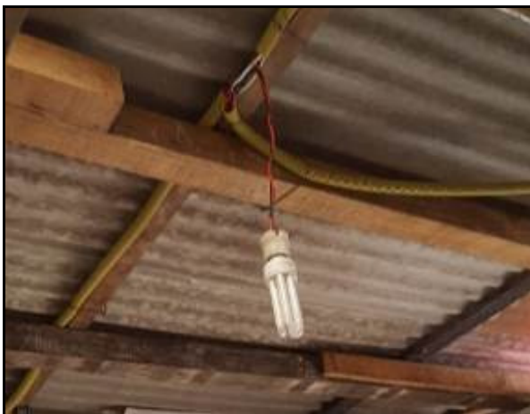
Figura 7 – Carpintaria – Iluminação sem proteção – Obra 1
