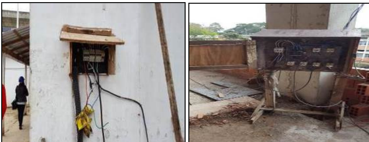
Figura 16 - Instalações Elétricas – Chave geral e painel elétrico – Obra 1
