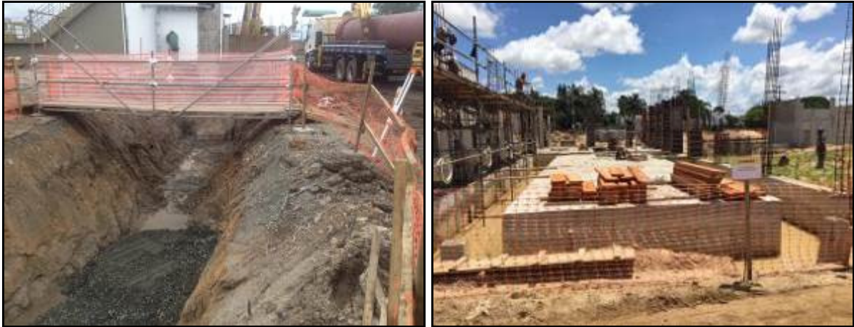
Figura 13 - Proteção contra quedas – valas abertas – Obra 2
