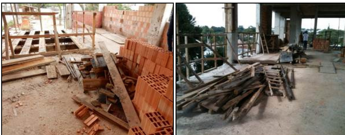
Figura 20 - Ordem e Limpeza – Material espalhado nas vias de circulação – Obra 1
