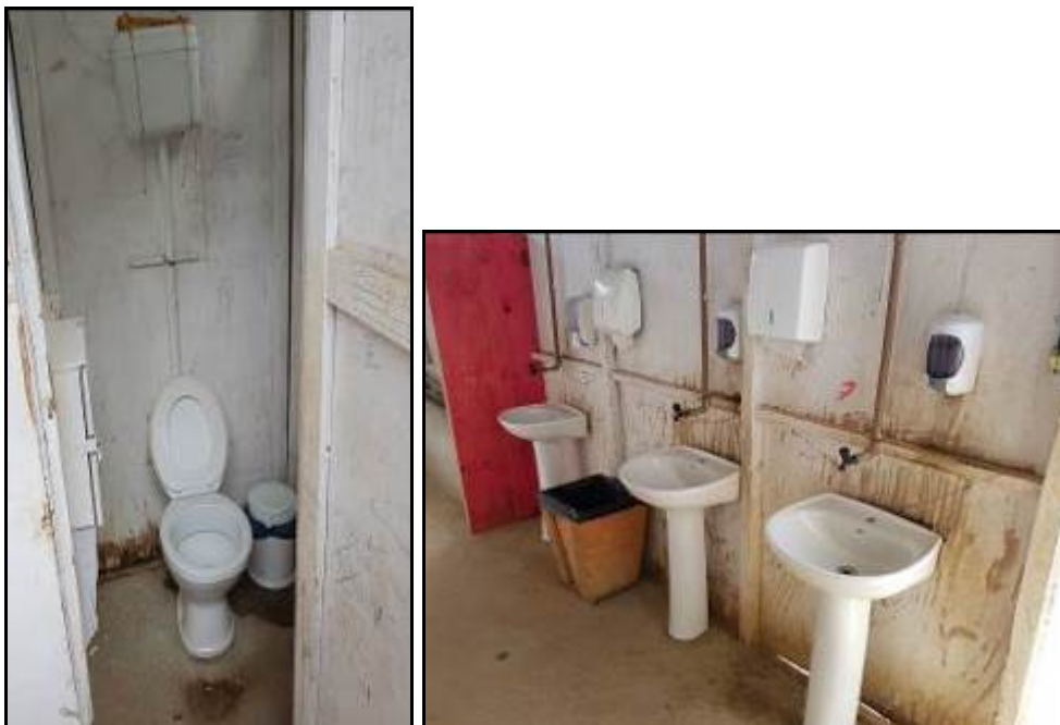
Figura 5 - Instalações Sanitárias – Lavatórios e sanitário – Obra 2 Fonte: o autor
