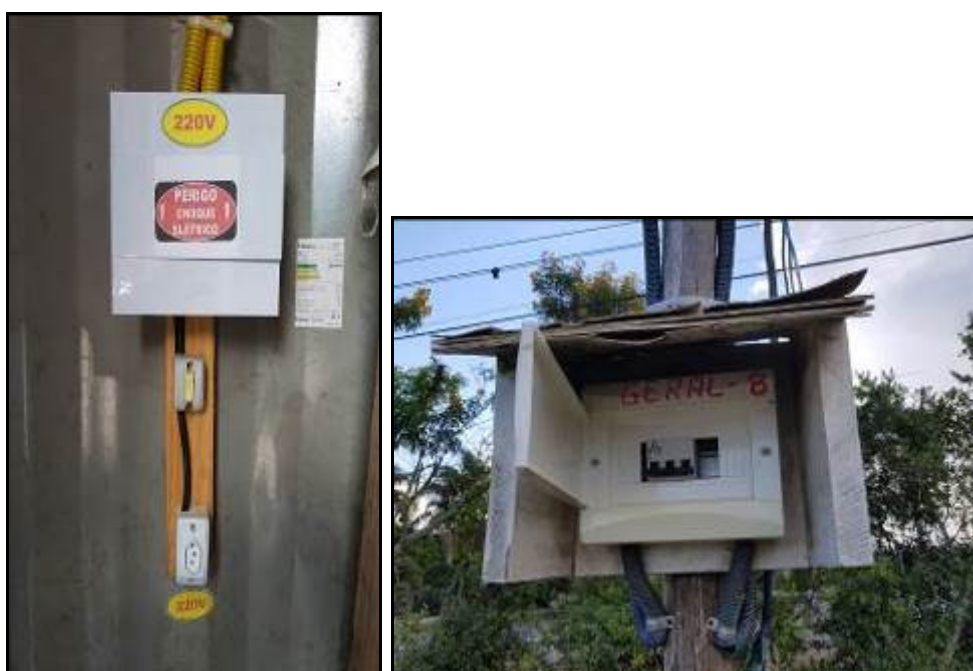
Figura 18 - Instalações Elétricas – Chave geral e padrão interno – Obra 2 Fonte: o autor
