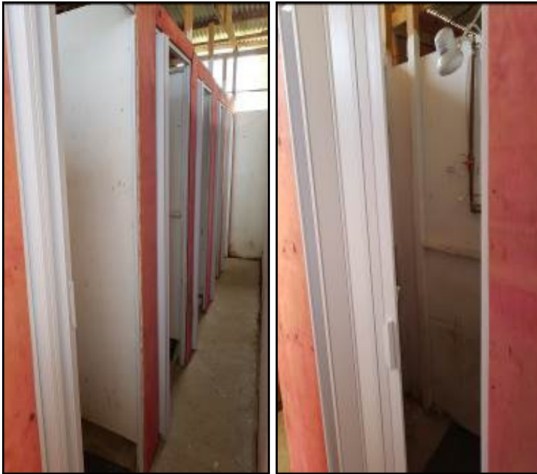
Figura 4 - Instalações Sanitárias – Box dos chuveiros – Obra 2 Fonte: o autor
