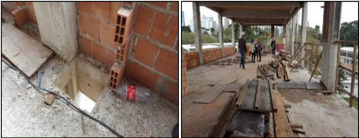
Figura 10 - Proteção contra quedas – abertura no piso e proteção no terceiro andar da obra – Obra 1
