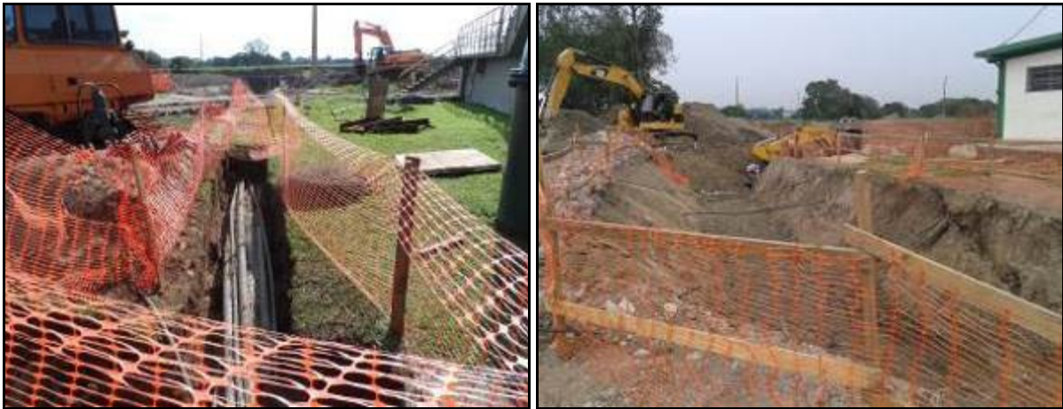
Figura 14 - Proteção contra quedas – valas abertas – Obra 2
