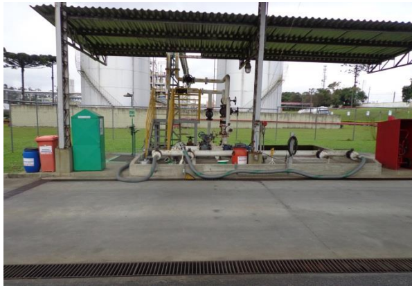
Figura 3 – Área isolada de descarga do metanol.
