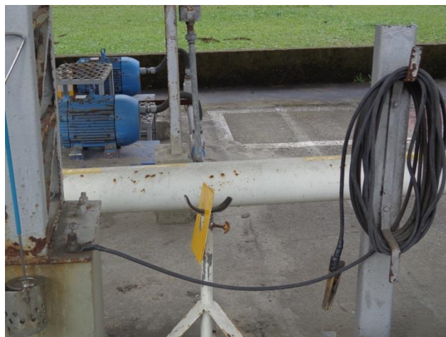
Figura 6 – Cabo de aterramento.
