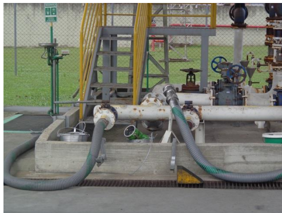
Figura 4 – Tubulações e conexões que ligam o caminhão ao tanque de armazenagem.
