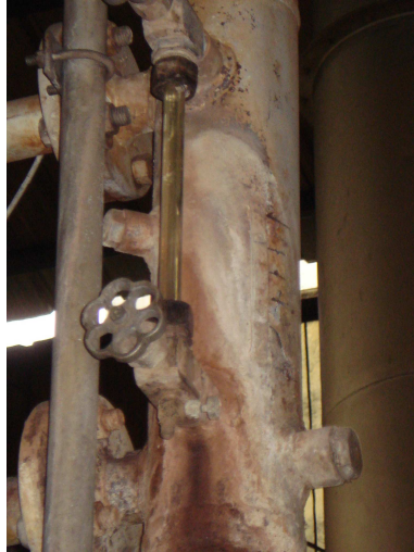
Figura 20: Mostrador de nível de água – Caldeira ATA GV - 403.
