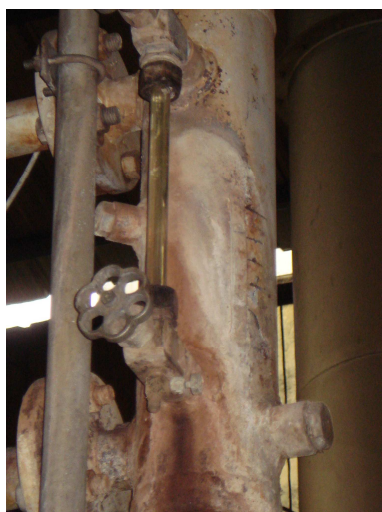
Figura 18: Mostrador de nível de água – Caldeira ATA GV - 403.
